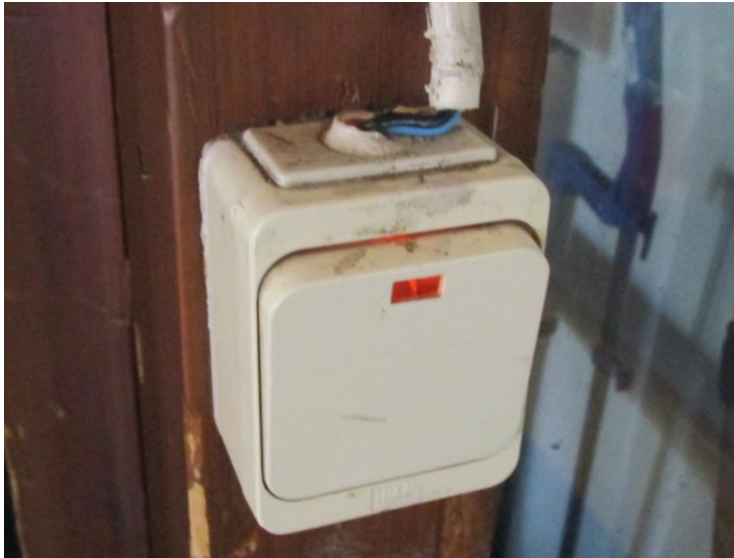
Kuva 5. Kytkimestä revitty kaapeli.
