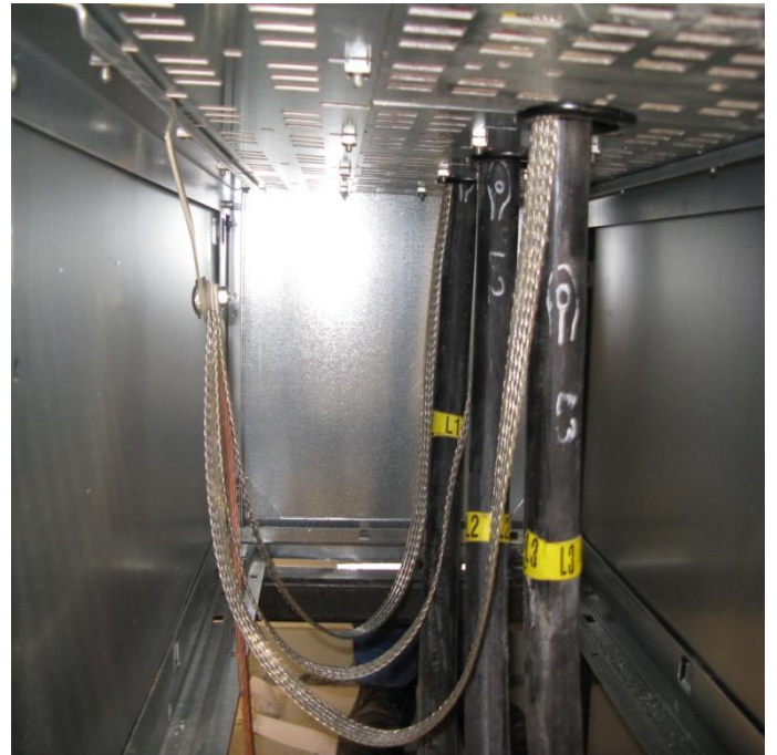
Kaapelipäätteen maadoitus kennossa.
