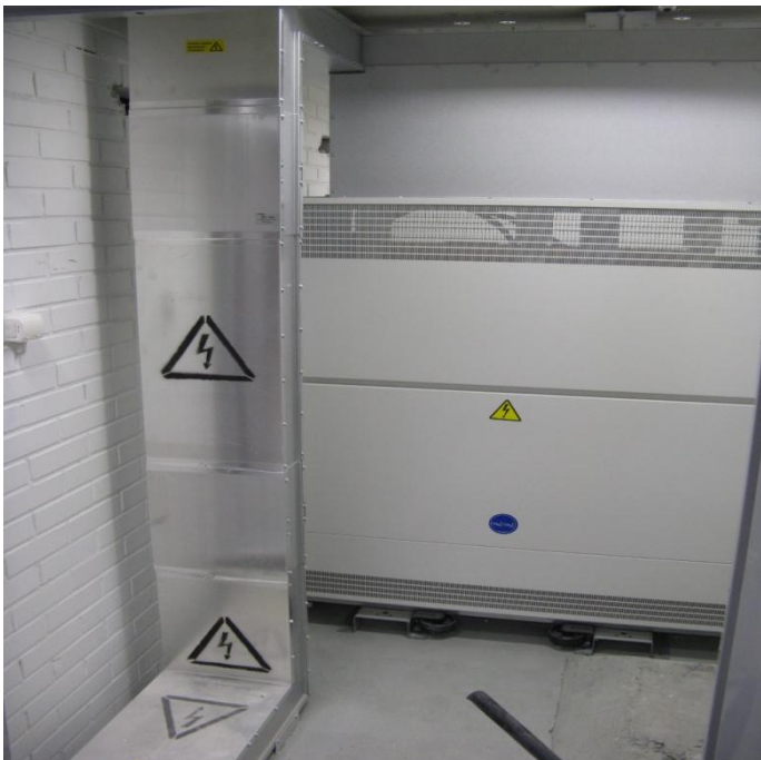
Muuntaja sekä pienjännitekiskosilta
