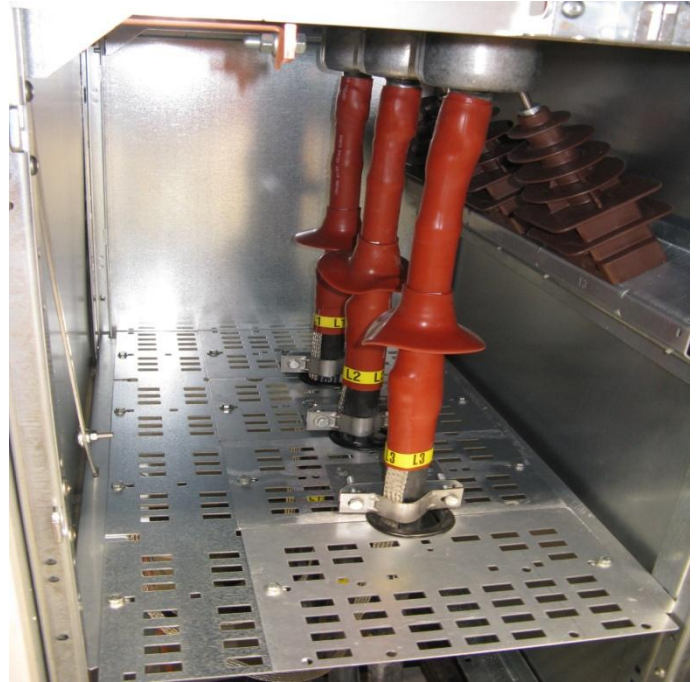
Enston 20Kv:n sisäpäätteet
