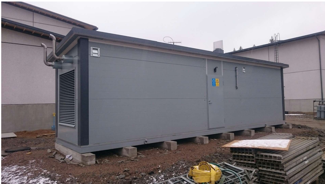
Kuva 8. Erilliseen konttiin sijoitettu varavoimalaitos. Suonenjoen Vesi Oy.
