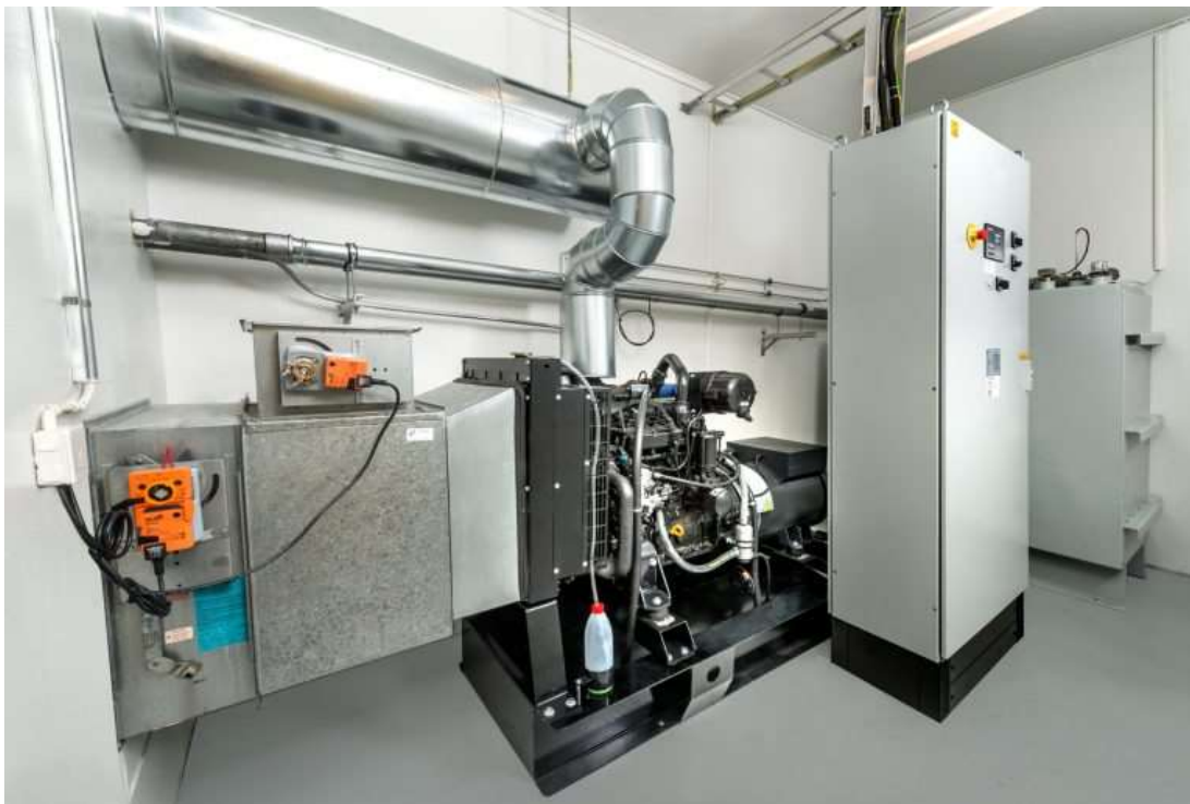
Kuva 9. Esimerkki varavoiman laitetilasta. AGCO Power Oy
