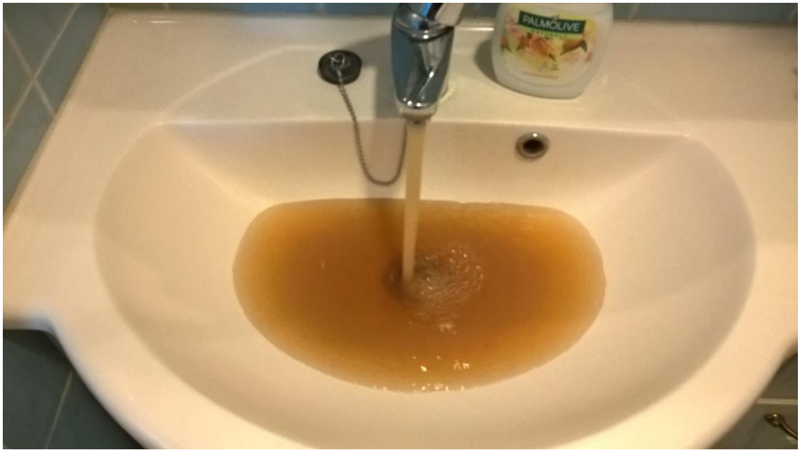
KUVA 12. Kerrostaloyhtiön pesuhuoneen vesipiste (Pirkanmaan Vedenkäsittely Oy 2017)
