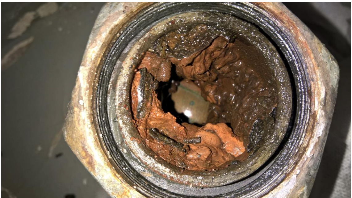
KUVA 11. 1970-luvulla rakennetun taloyhtiön kylmän käyttövesiputken säätöventtiili (Pirkanmaan Vedenkäsittely Oy 2017)
