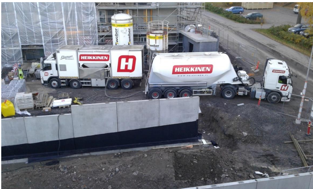
Kuva 1. Fesconin pumppauskalustoa ja taustalla irtosiiloja.
