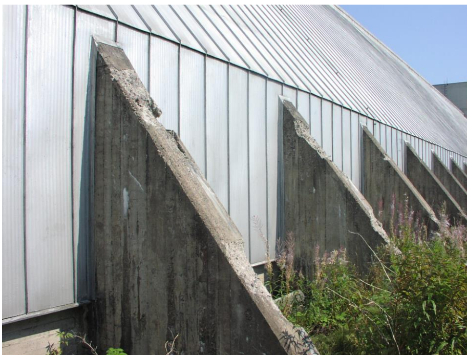
Kuva 5. Pitkälle edenneen pakkasrapautuman aiheuttamaa betonin lohkeilua.
