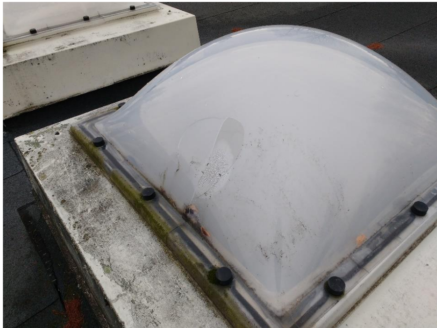
Kuva 10. Kattoikkunan kupu on rikki.
