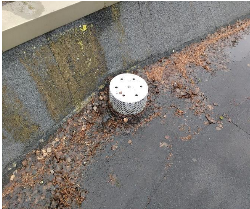
Kuva 8. Kattokaivot tukkeentuvat roskasta.
