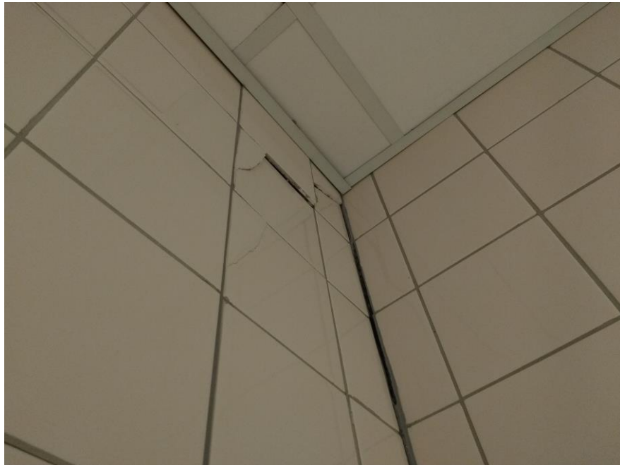
Kuva 16. WC-tilan seinä on liikkunut ja laatat ovat halkeilleet pahasti.
