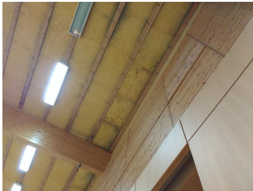
Kuva 17. Liikuntasalin katossa on nähtävissä selkeitä kosteusjälkiä.
