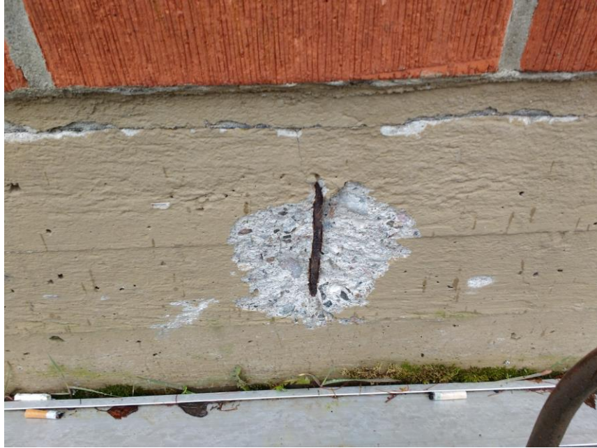
Kuva 2. Sokkeli rapautunut ja raudoitukset näkyvissä. Raudoitukset ovat jääneet hyvin lähelle pintaa.
