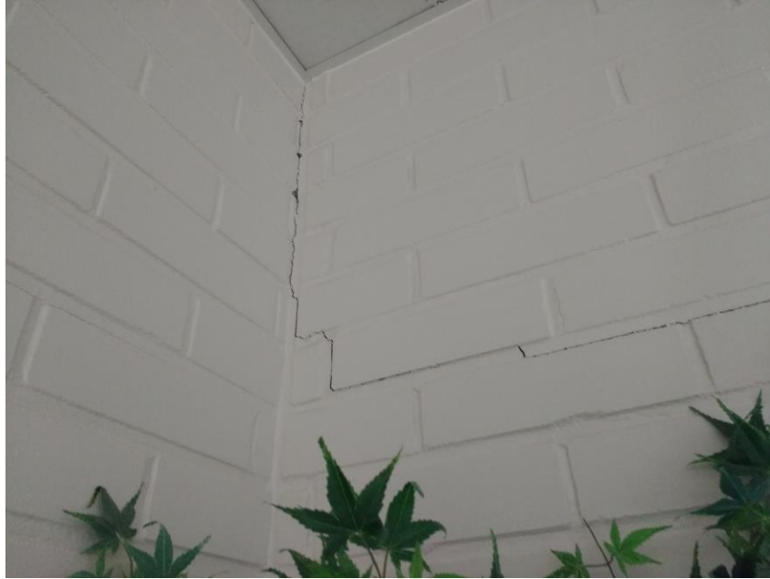
Kuva 14. Aulan seinissä on lähes kauttaaltaan halkeamia.
