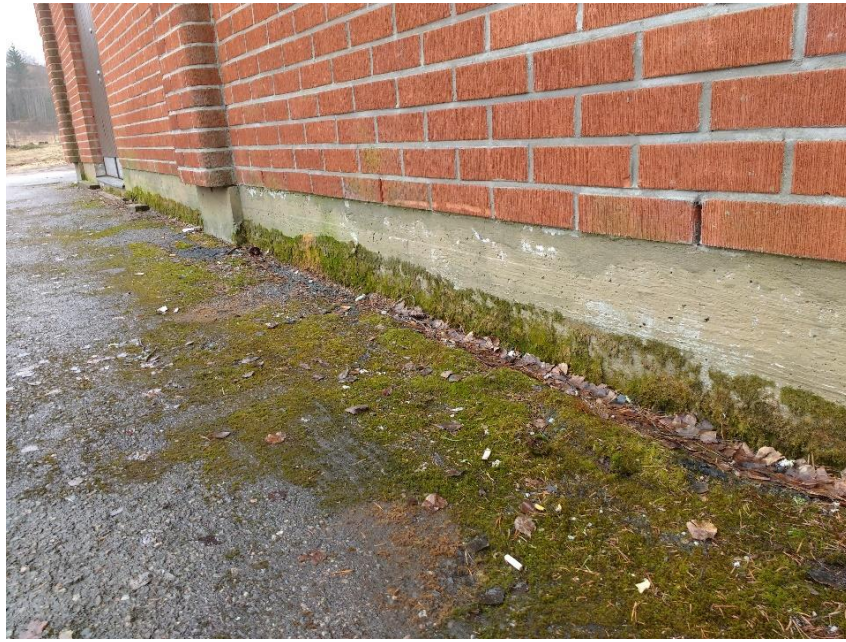
Kuva 3. Sokkelin pinnassa kasvaa sammalta.
