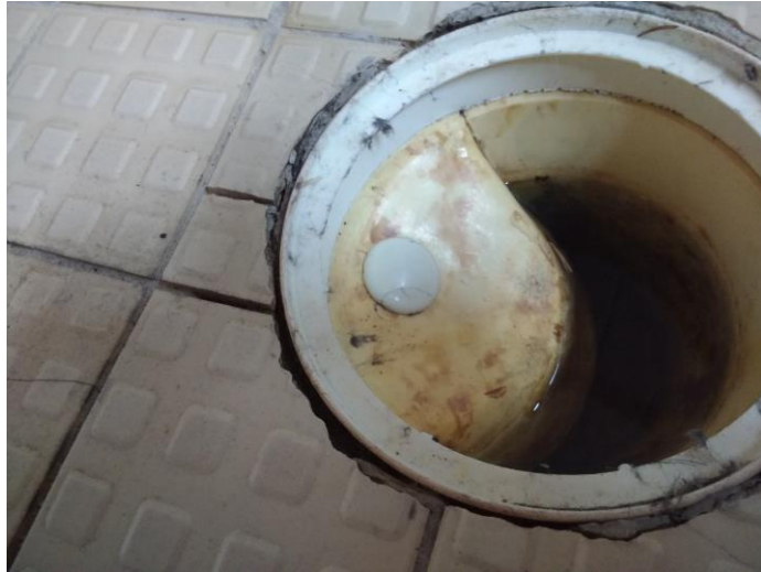
Kuva 20. Miesten suihkutilan lattiakaivon ympäriltä on saumat hävinnyt kokonaan.
