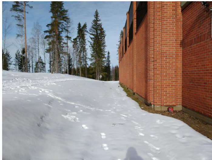
Kuva 5. Maankallistukset ovat rakennukseen päin
