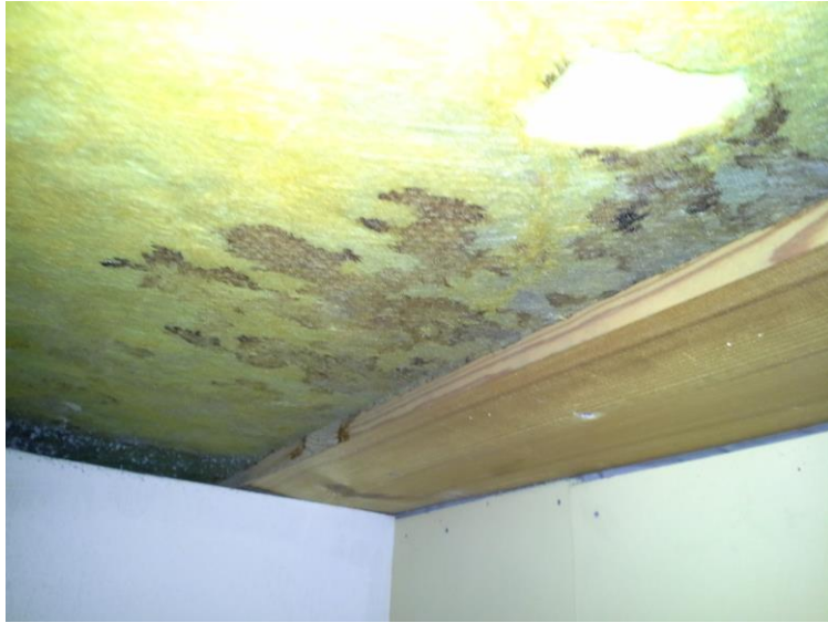
Kuva 18. Kosteusjälkiä liikuntasalin katossa.
