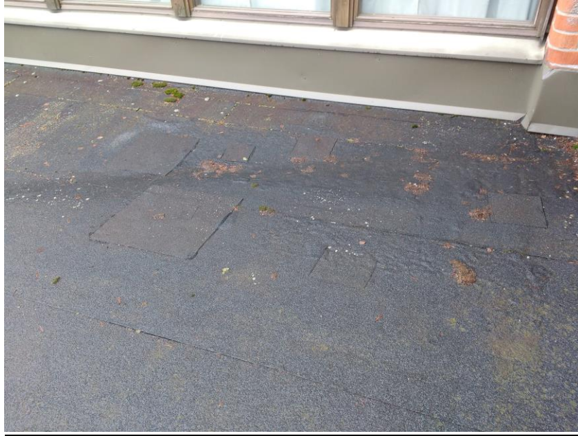
Kuva 5. Kattoa paikattu useita kertoja.
