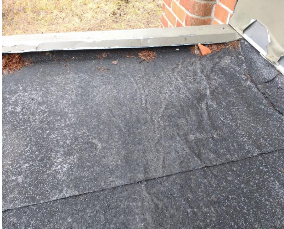
Kuva 9. Huopakatteen sirotepinta on osittain kulunut lähes kokonaan.
