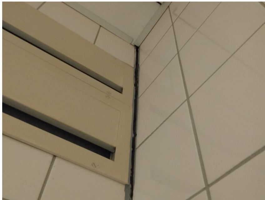
Kuva 15. WC-tilan seinä on liikkunut ja sauma on revennyt nurkasta melko reippaasti.
