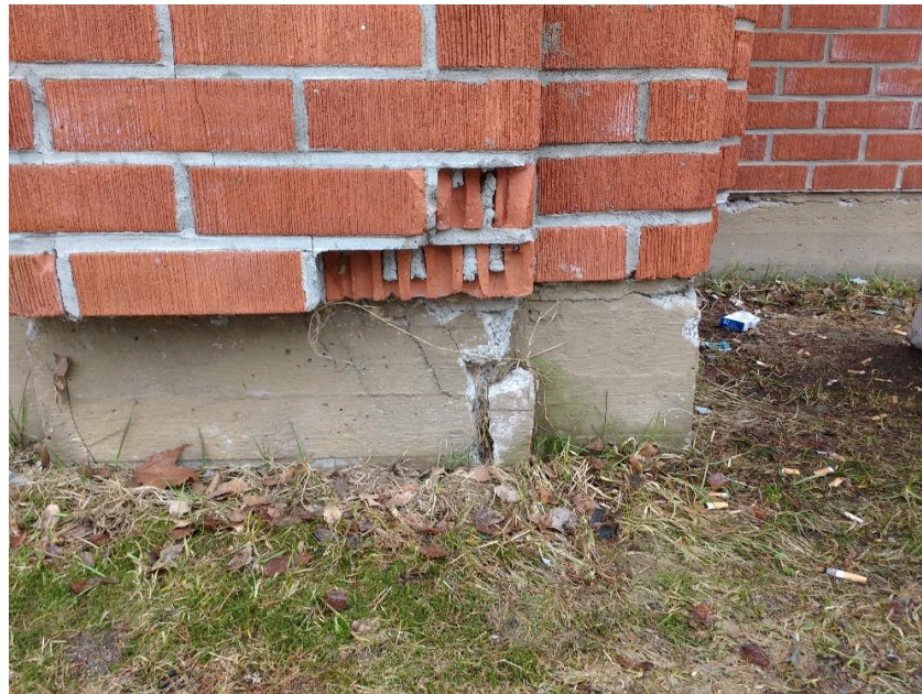
Kuva 1. Sokkeli halkeillut pahoin rakennuksen takaosassa.
