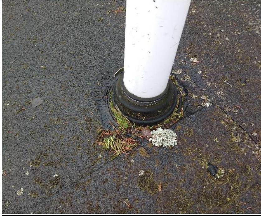
Kuva 7. Tuuletusputken läpivienti ei näytä kovin vedenpitävältä
