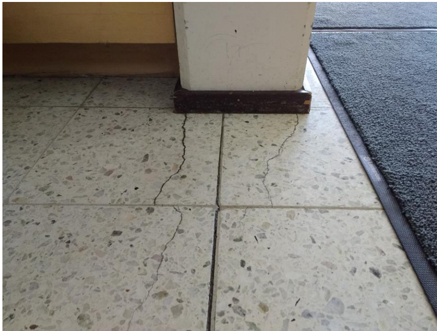
Kuva 13. Lattia on noussut pilarin juuresta ja laatat ovat halkeilleet pahasti, myös pilari on kallistunut.
