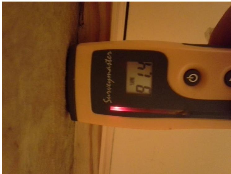
Kuva 19. Kosteusmittarilla saatiin todella suuria lukemia liikuntasalin katosta.
