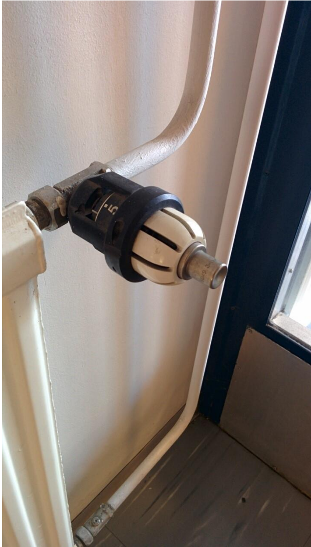
Kuva 27 Termostaattinen patteriventtiili (Juho Hesso, 2017)
