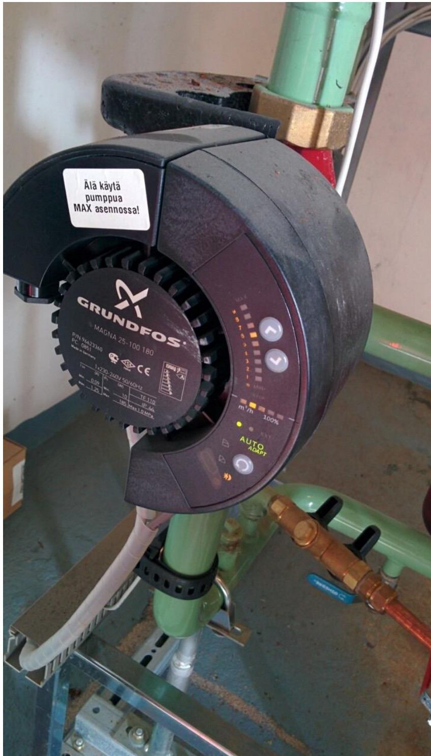
Kuva 25 Kiertovesipumppu (Juho Hesso, 2017)
