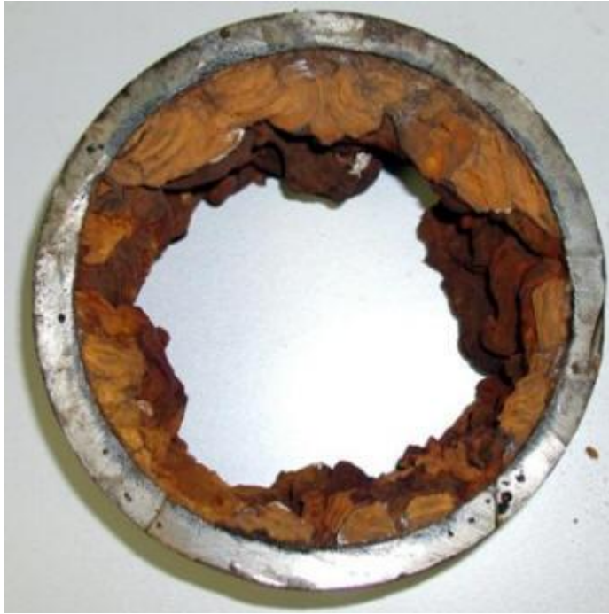
Kuva 20 Korroosio putkessa. (Sperchemical www-sivut. Viitattu 2017)
