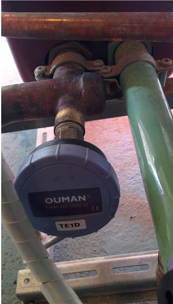
Kuva 22 Lämpötila-anturi (Juho Hesso, 2017)
