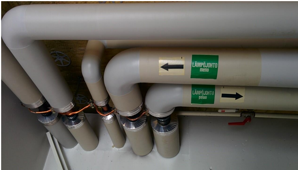
Kuva 23 Käyttövesi- sekä lämmitysrungot (Juho Hesso, 2017)
