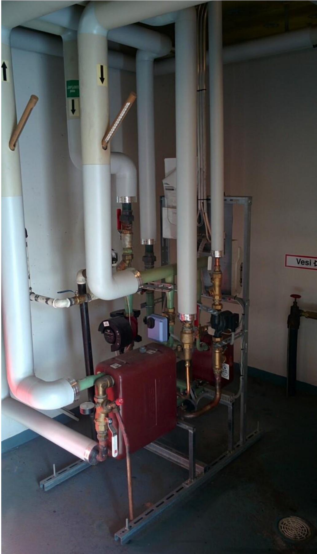
Kuva 21 Kohteen kaukolämpöpaketti (Juho Hesso, 2017)
