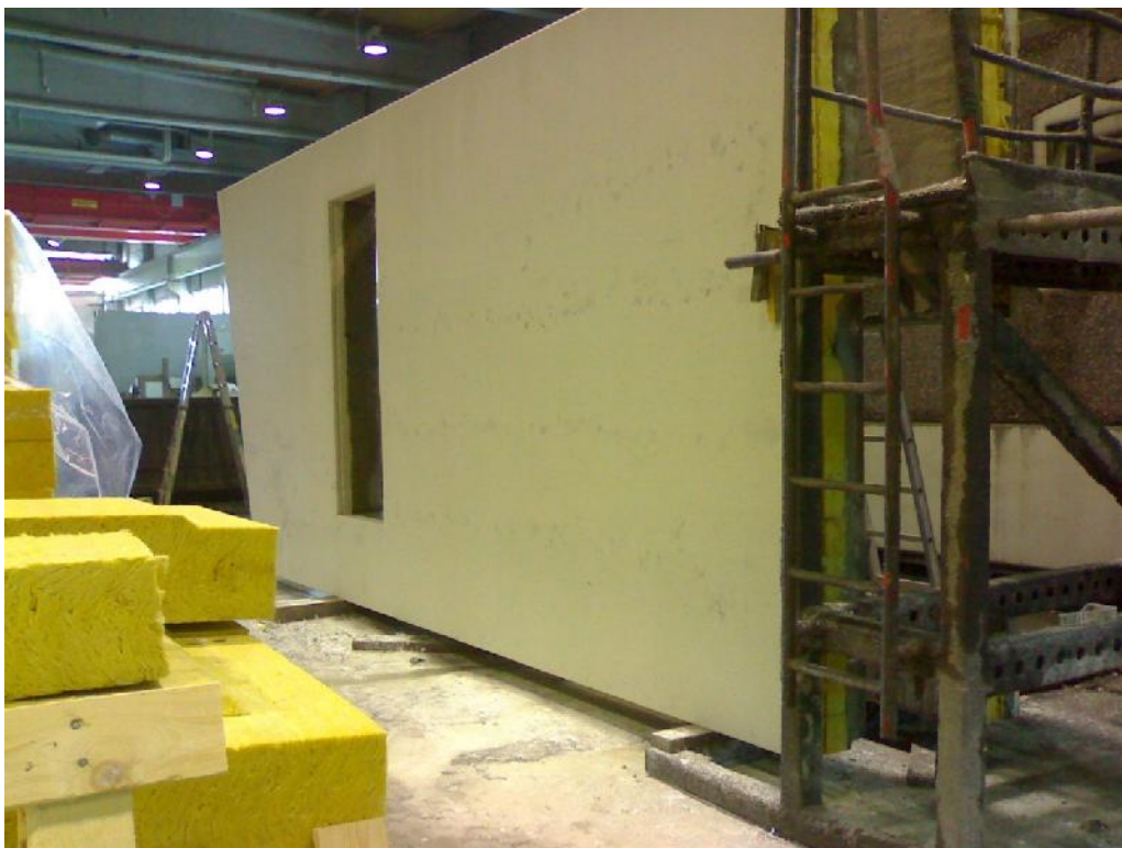
Kuva 11. Valkobetonipinnassa näkyvää likaisuutta, joka on pudonnut puhdistettuun muottiin muotin yli nosturilla kuljetetusta betonikuupasta (Antti Savinainen 2013)
