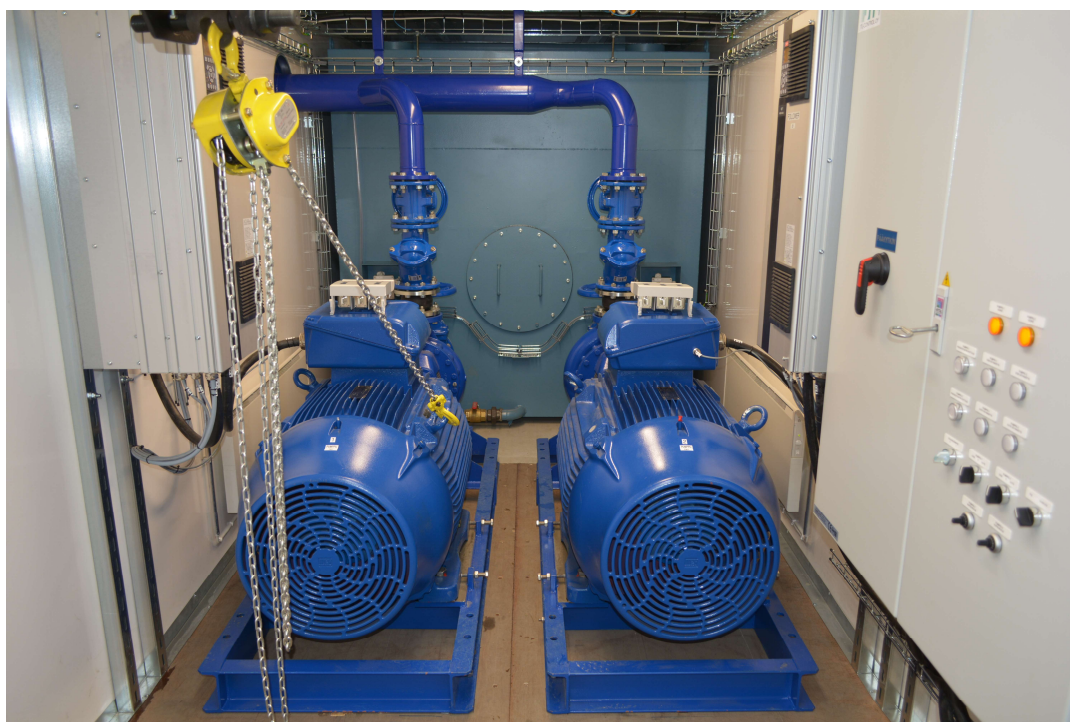
Kuva 2. Kuva moottoreista pumppaamokontissa, sekä taajuusmuuttajat sivuseinillä.
