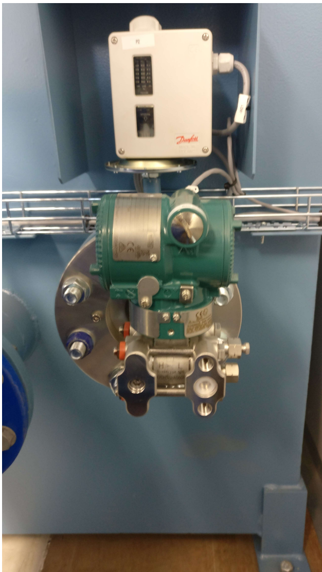
Kuva 3. Pressostaatti sekä painelähetin.
