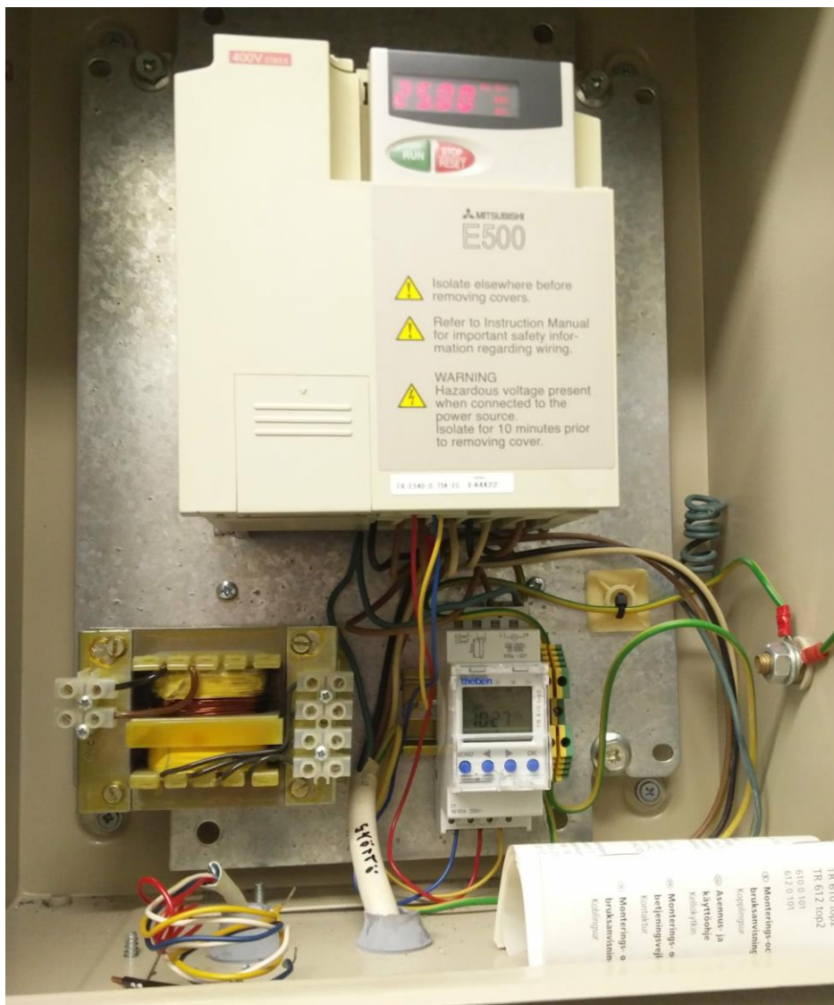
KUVA 5. Väärin asennettu taajuusmuuttaja kerrostalon sähköpääkeskuksessa
