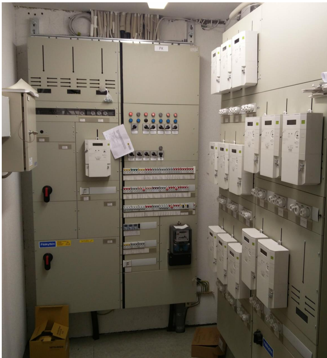
KUVA 6. Uudet mittarit sähköpääkeskuksessa
