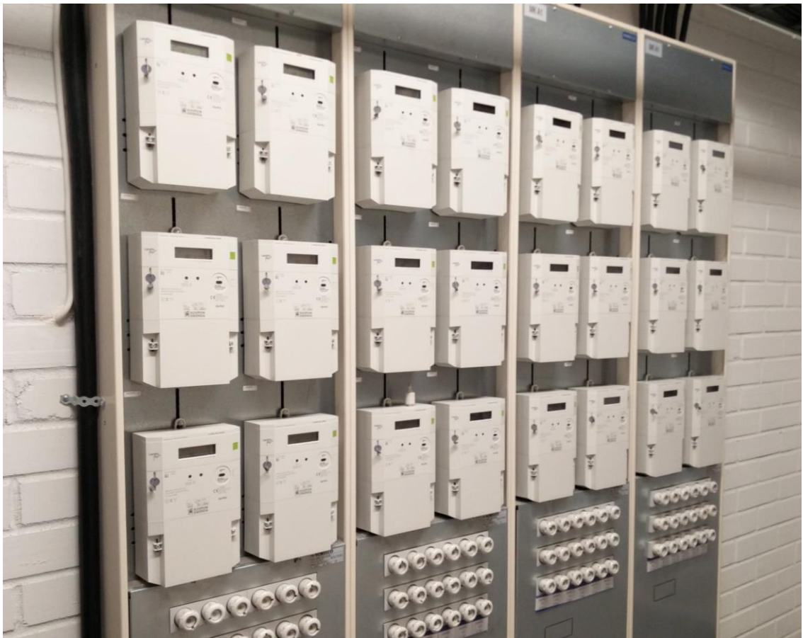
KUVA 1. Landis+Gyr E450 G3 -mittareita asennettuna häiriöllisen kerrostalon sähköpääkeskuksessa
