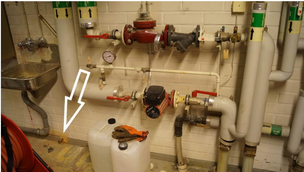
KUVA 7. Purkuputki kahden varaajan varoventtiileiltä
