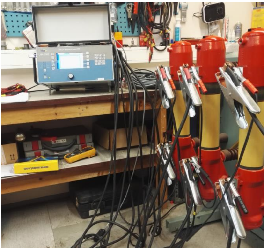
Kuva 18. Katkaisijan pääkoskettimiin on kytketty virta -sekä jännitekaapelit mittaamaan staattista ja dynaamista resistanssia (Ylitalo 2017.)
