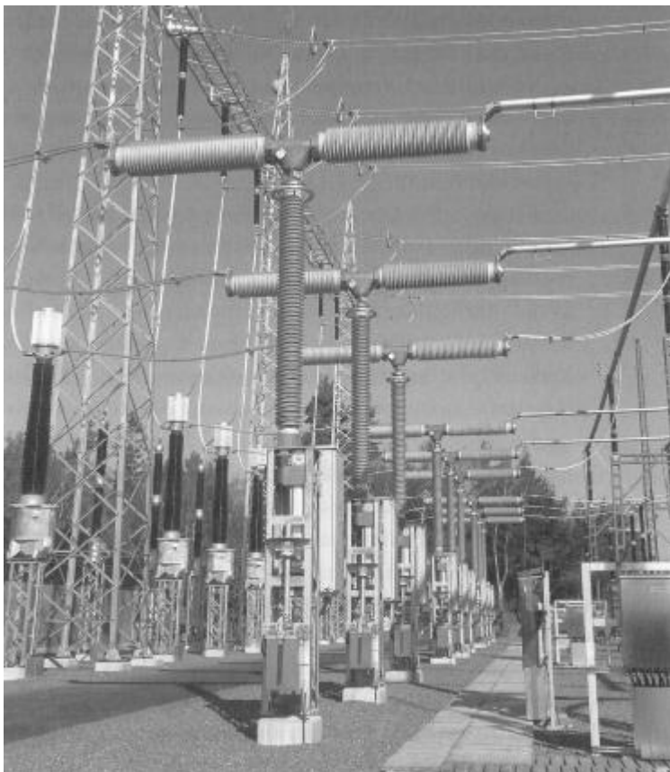
Kuva 2. Yksivaiheisesti ohjattuja, kahdella katkaisupäällä per vaihe varustettuja erottavia 400kV:n katkaisijoita (Elovaara & Haarla 2011, 187.)
