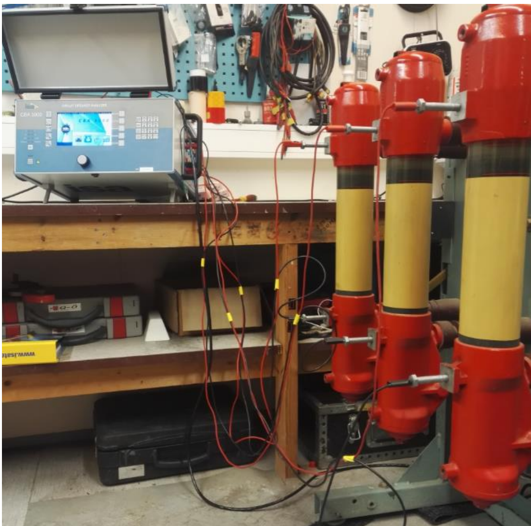
Kuva 17. Katkaisijan pääkoskettimiin on kytketty johtimet mittaamaan toiminta-aikoja. (Ylitalo 2017.)
