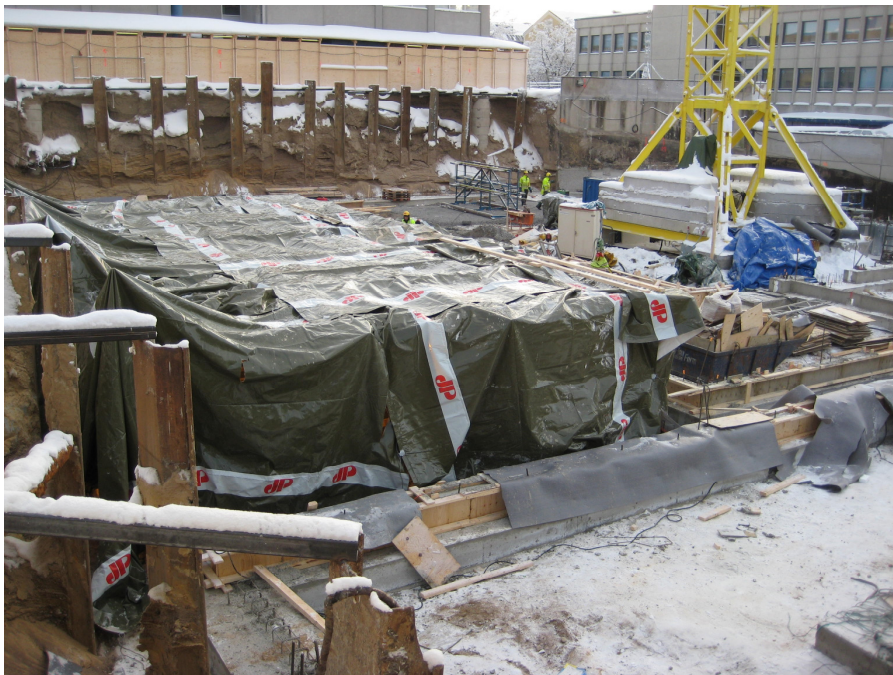
Kuva 10. Huputettu väestönsuoja, lämmitys sisäpuolelta kuumailmalämmittimillä.
