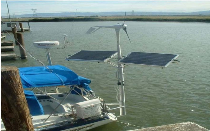
Kuva 11. Aurinkopaneelin ja tuuligeneraattorin yhdistelmäasennus purjeveneessä. (kuvalähde: http://www.ocipenergy.com/downloads/solar-stik-marine/solar-stik-product-data.pdf )
