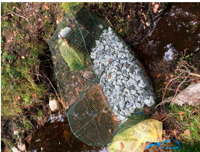
KUVA 2. Kalkkisuodatin, malli katiska (kuva Kalle Karosto).
