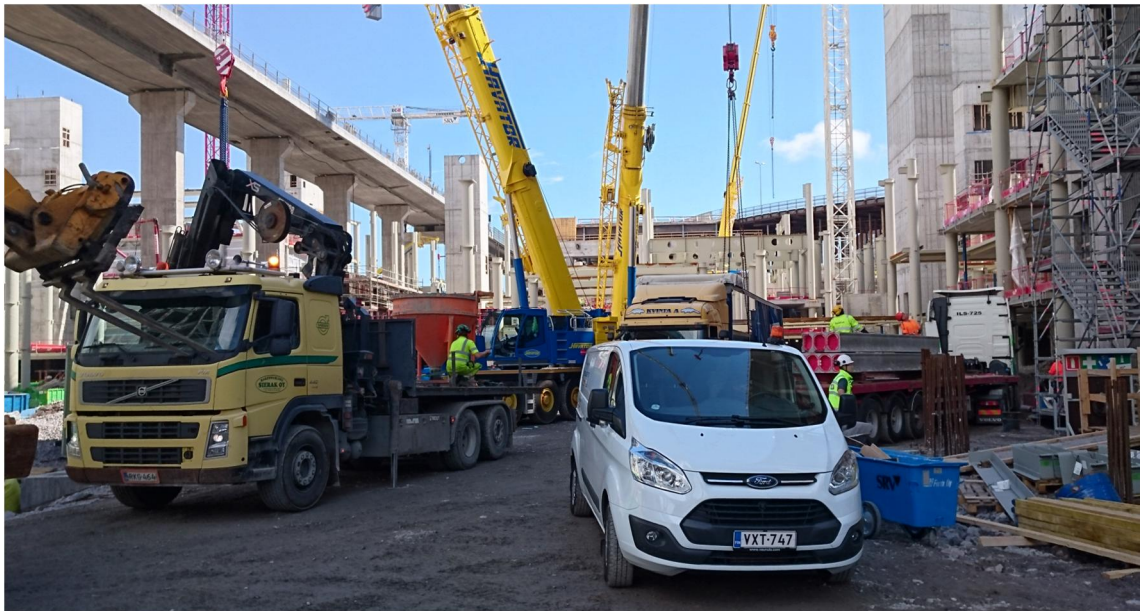
Kuva 7. Tilan puute pahimmillaan työmaa-alueella. Kulkuväylä työalueelle sijaitsi kuvan keskellä. Kuvassa havaittavissa kaksi ajoneuvonosturia, kaksi rekkaa, kuorma-auto, kurottaja sekä pakettiauto.
