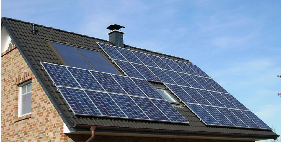
Kuva 12. Kiinteästi suunnatut aurinkosähköpaneelit (Marathon Roofing & Services, 2010)
