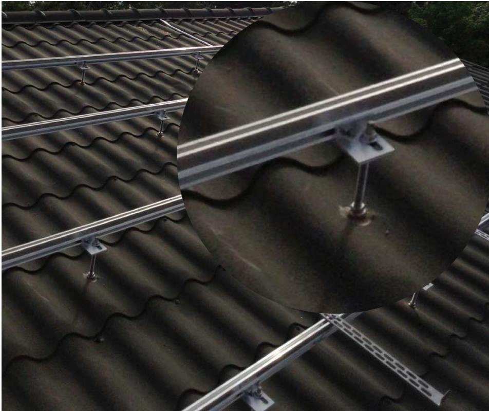
Kuva 15. Alumiiniprofiilin käyttö kattotuennassa. (Aurinkovirta.fi)
