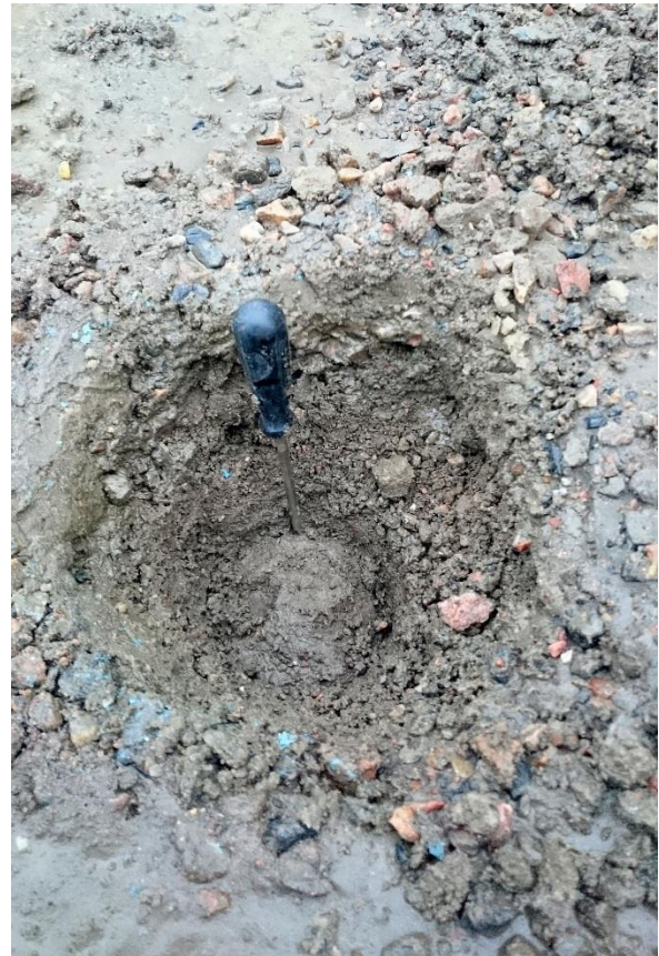
Kuva 34. Stabiloidun rakenteen kairaus marraskuussa 2015. Rakenne on luja, mutta kairasydämmen irrottaminen ehyenä ei onnistu (Kaira ei yllä rakenteen läpi – sydän ei katkea).
