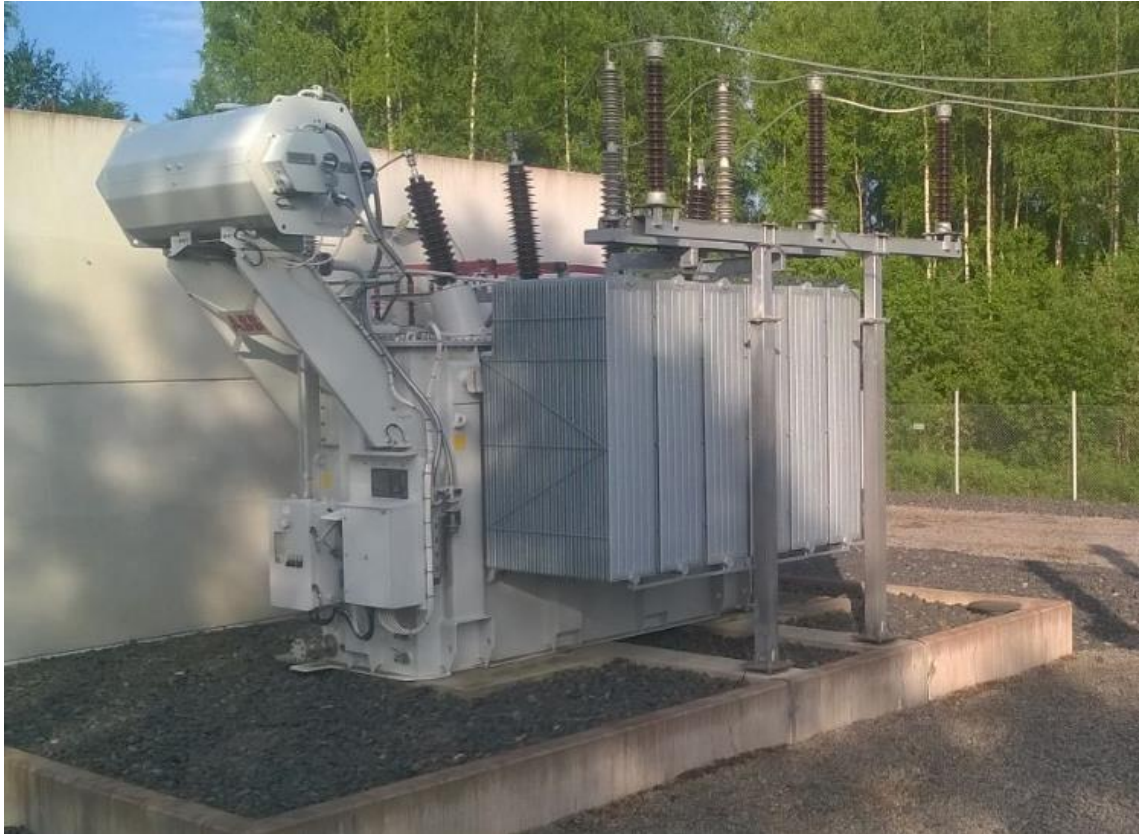
KUVA 3. Öljyeristeinen, paisuntasäiliöllinen tehomuuntaja (Kortet & Pihkoluoma 2016).
