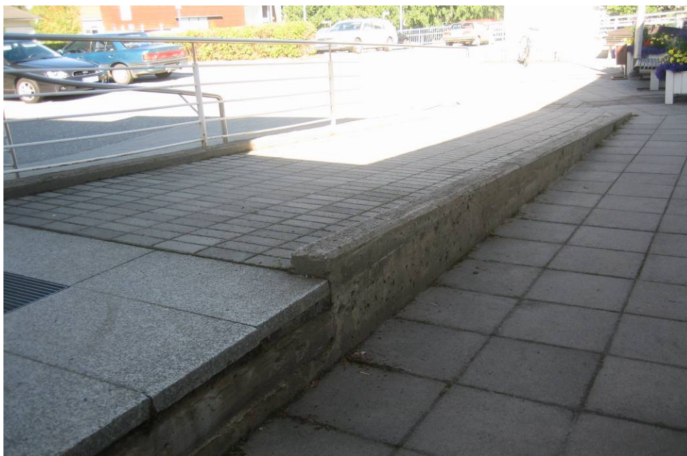
Kuva 22. Pitkä luiska, josta puuttuu suojakaide (Sotkamon terveysasema)
