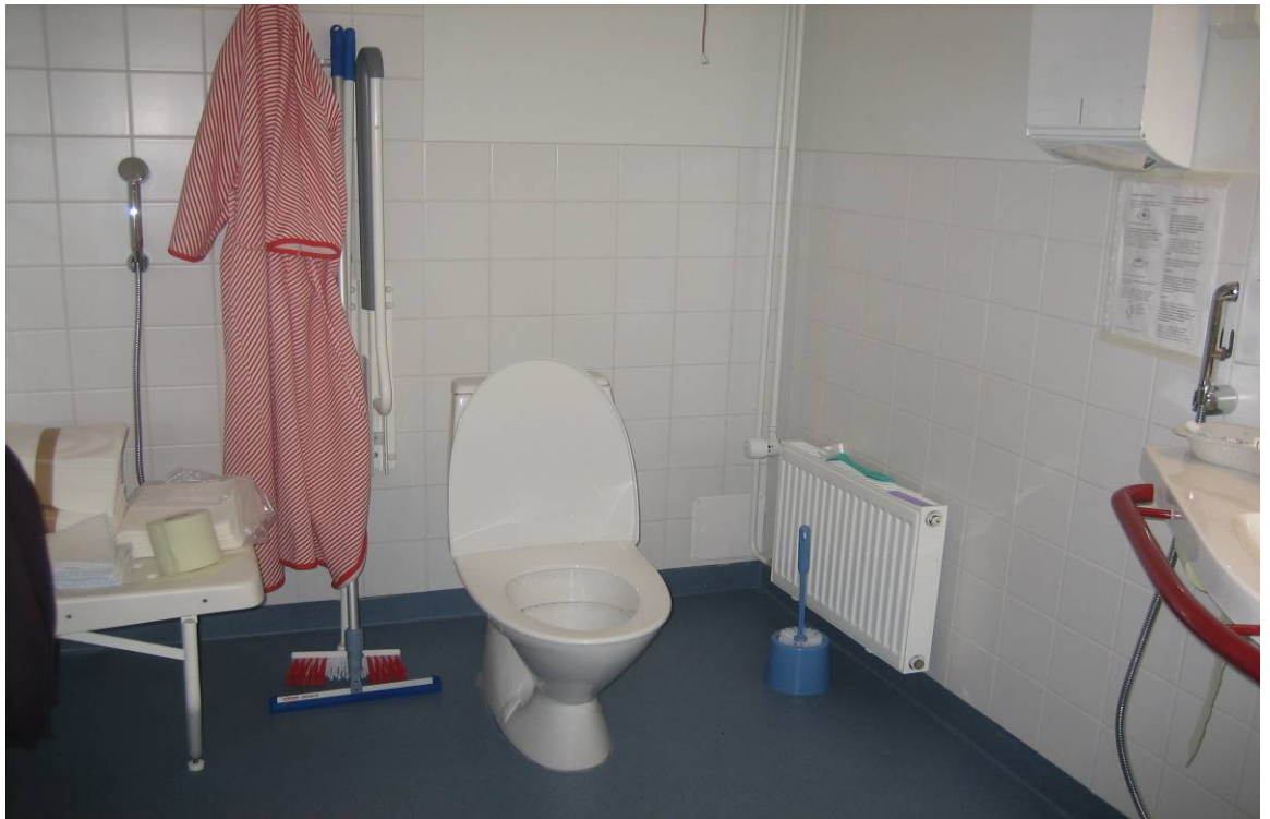
Kuva 27. Toisen tukikahvan puuttuminen wc-istuimelta
