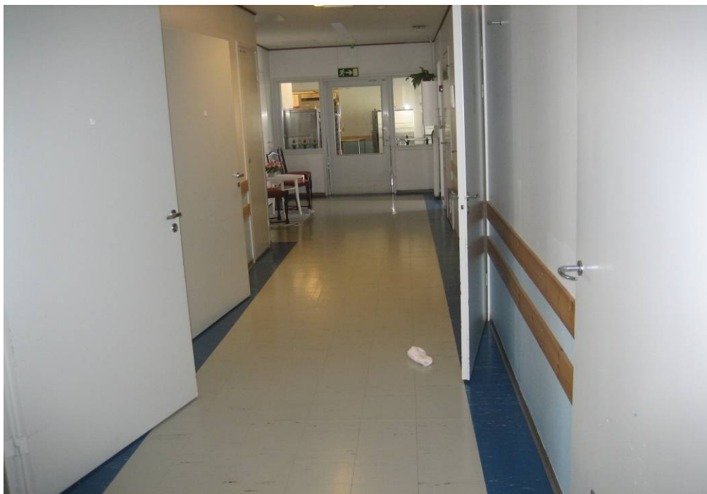
Kuva 31. Käytävätilojen ahtaus (Kuhmon terveysasema)
