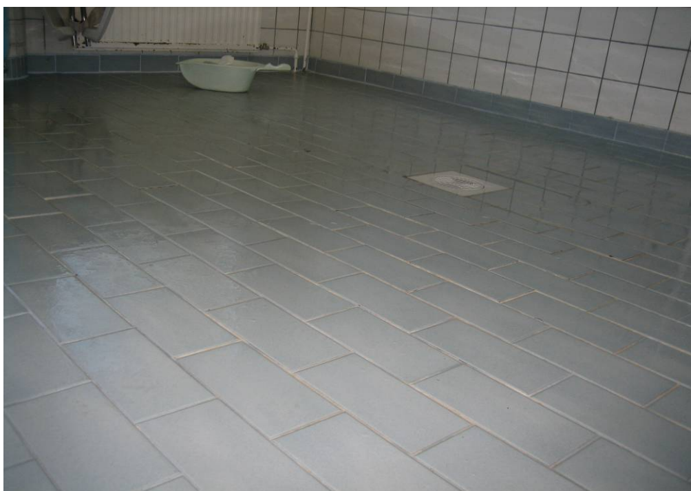
Kuva 36. Liukaspintainen pesuhuoneen lattia (Ristijärven terveysasema)
