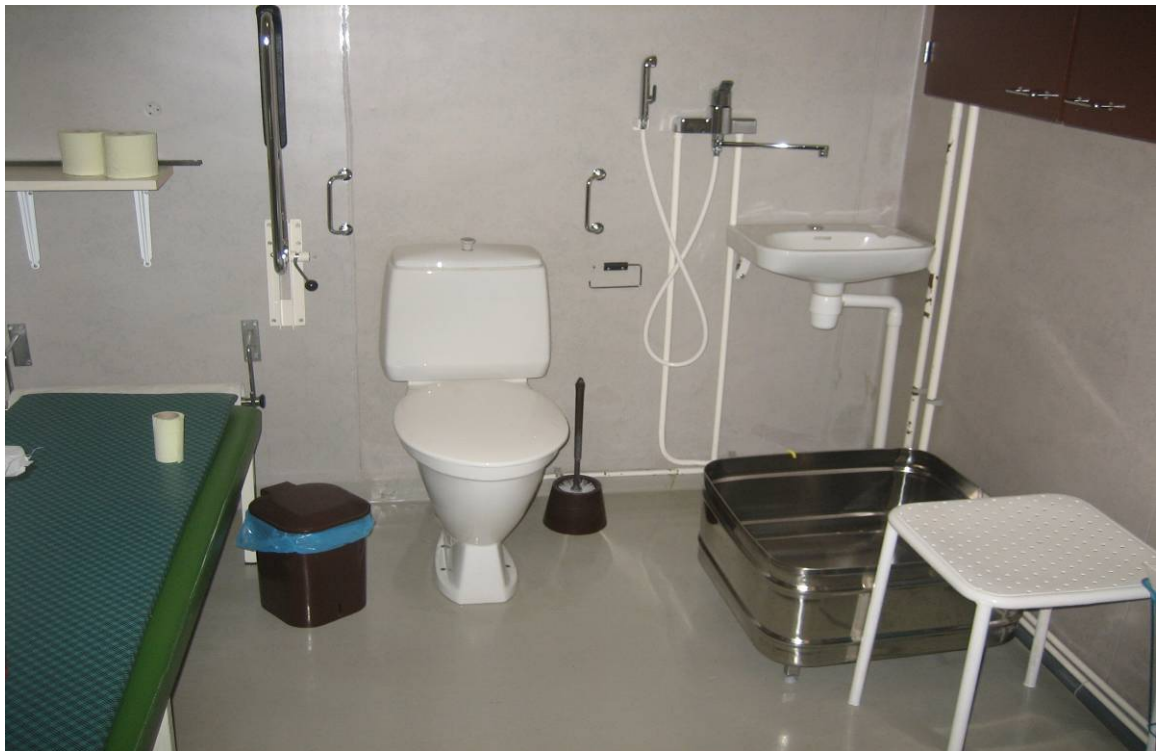
Kuva 24. Liikuntaesteisille tarkoitettu wc
