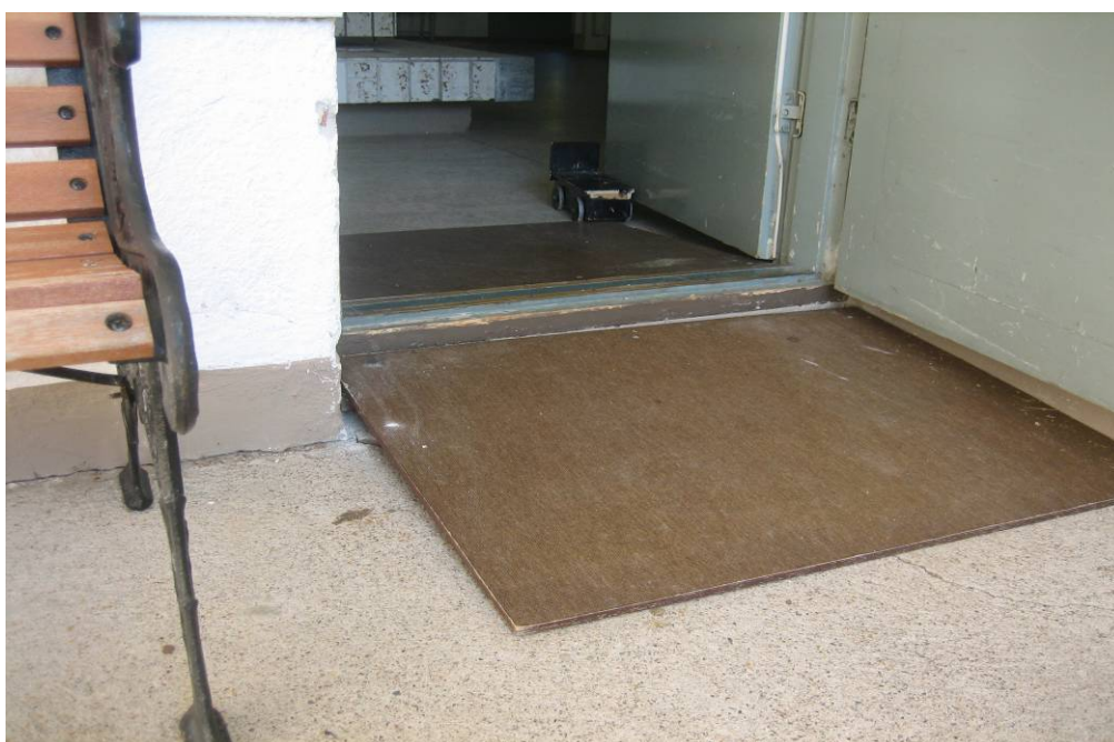
Kuva 12. Korkea kynnyks ja irtonainen vaneriluiska (Hoitokoti Toppila Kajaani)
