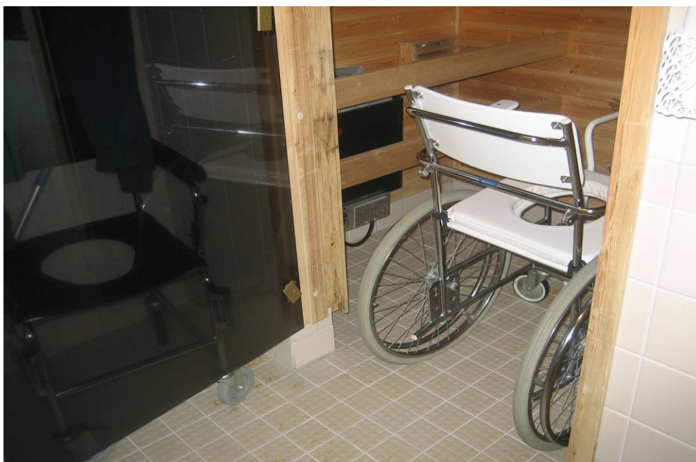
Kuva 14. Ahdas ja toimimaton saunatila (Hoitokoti Toppila Kajaani)
