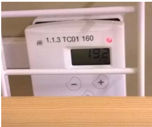
KUVA 21. Liikuntasalin lämpötilasäädin positiointitunnuksella 1.1.3 TC01 160 (Kuva: Aki Kortetmäki 2016)
