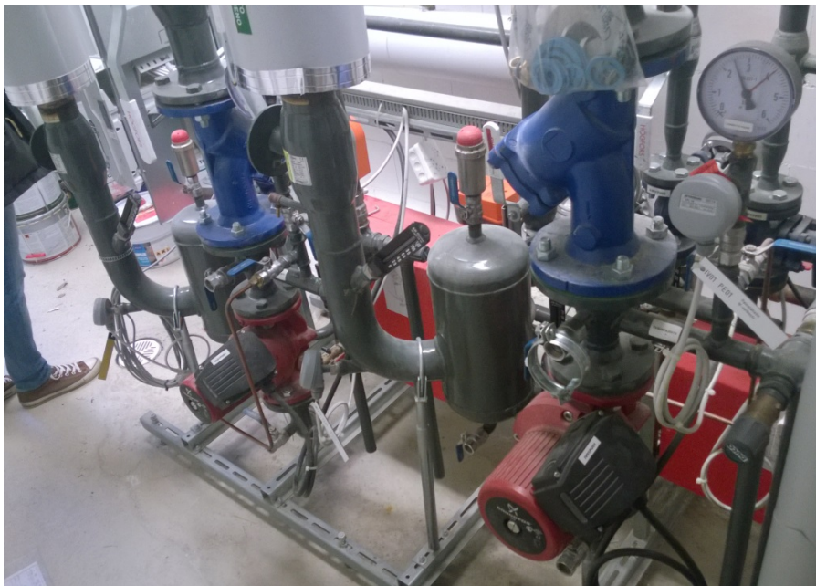
KUVA 19. Kaukolämmön alajakokeskus (Kuva: Aki Kortetmäki 2016)
