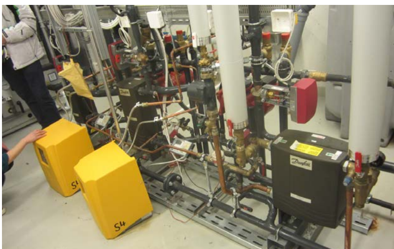
KUVA 29. Kaukolämmön alajakokeskus ja automaattiset ilmanpoistimet (Kuva: Aki Kortetmäki 2016)
