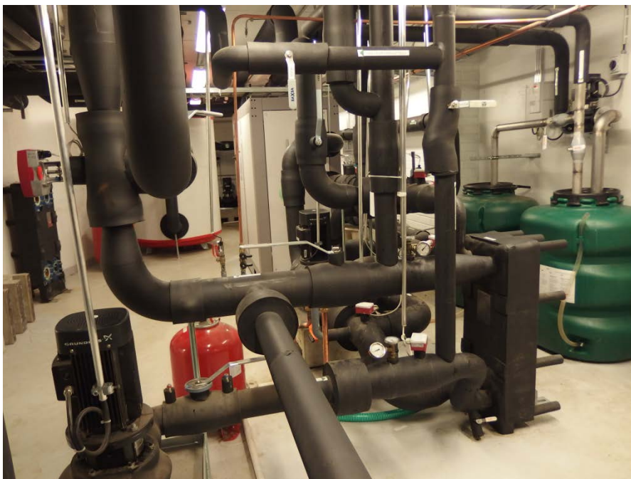
KUVA 49. Jäähdytysvesiputkisto ja vedenjäähdytyskoje (Kuva: Sakari Uusitalo 2015)
