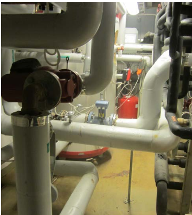
KUVA 7. Lämmönjakohuoneen alempi kerros takanurkasta kuvattuna, perällä lämminvesivaraajat (Kuva: Suvi Virta 2016)
