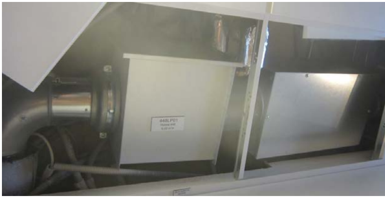
KUVA 45. Jälkilämmityspatteri huoneessa 448 (Kuva: Suvi Virta 2016)
