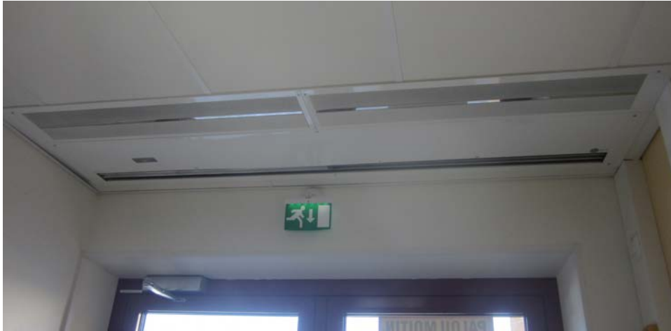
KUVA 40. Toimimaton oviverhopuhallin (Kuva: Suvi Virta 2016)
