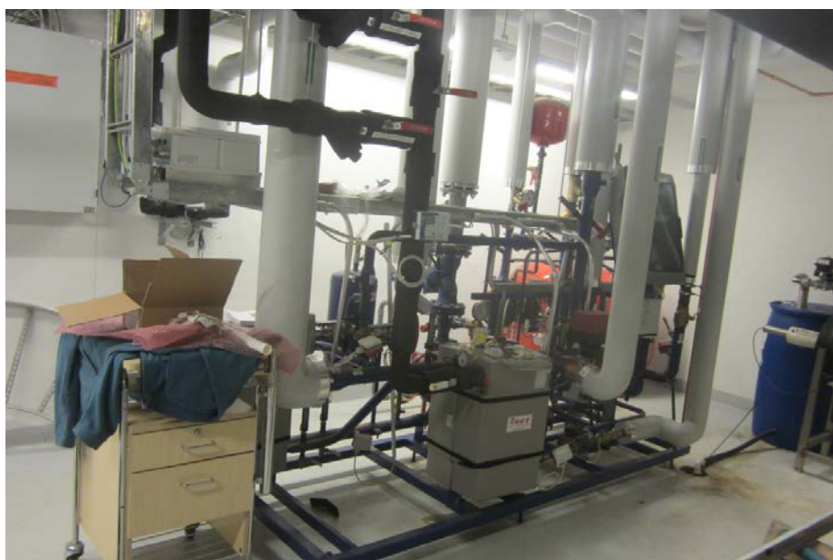
KUVA 44. Kaukolämmön alajakokeskus (Kuva: Suvi Virta 2016)
