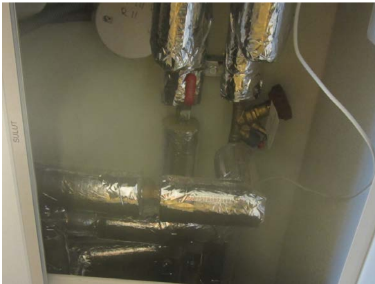
KUVA 46. Lämpimän veden meno- ja paluuputki (Kuva: Suvi Virta 2016)
