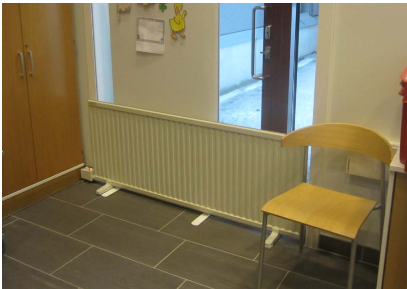
KUVA 10. Palvelutiskin taakse sijoitettu sähköpatterit (Kuva: Suvi Virta 2016)
