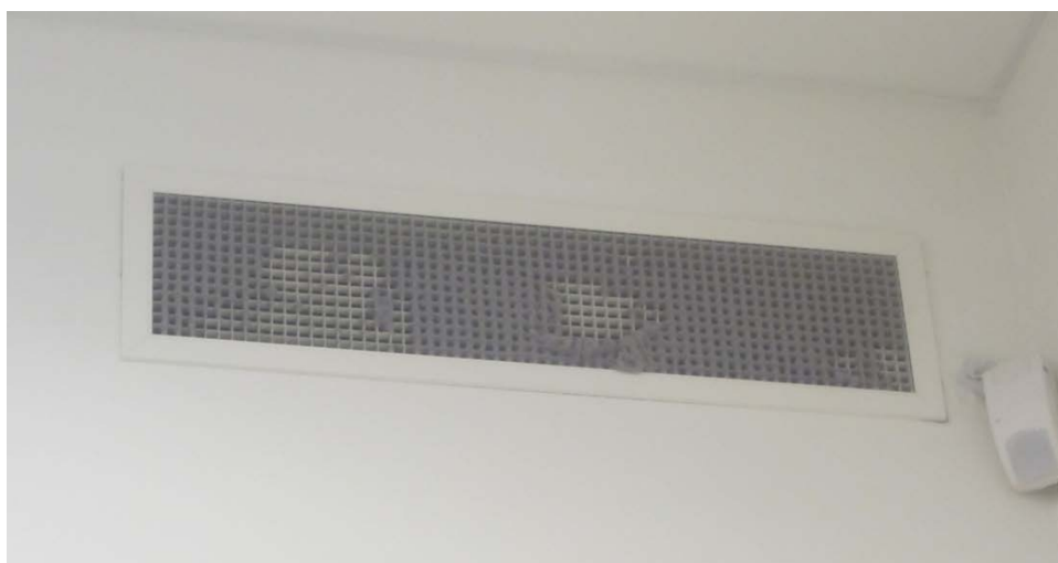
KUVA 32. Ilmanvaihdon poistoilman päätelaitteet olivat huomattavan pölyisiä (Kuva: Suvi Virta 2016)
