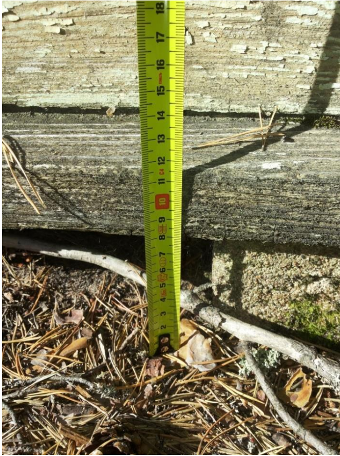
Kuvio 7. Rakennuksen riittämätön tuuletus (kuva Marko Sarkkinen).
