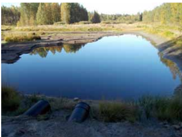
Kuva 12. Ruukkisuon kosteikolle tulevat rumpuputket 27.09.2014.
