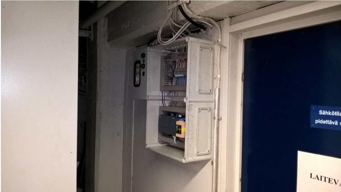
KUVA 48. Kotelot ja laitteistot paikallaan
