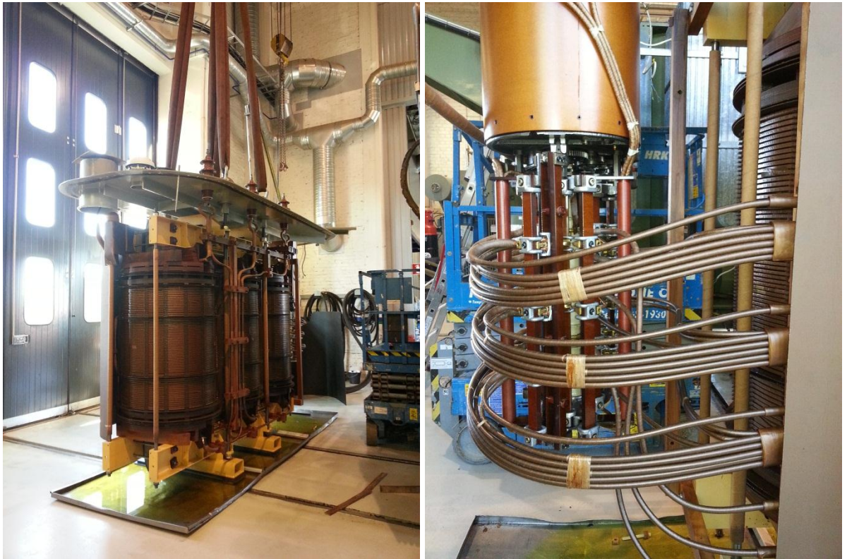
Kuva 17. Muuntajan aktiiviosa on nostettu säiliöstä ulos tarkempaa tarkastusta varten. Oikealla kuvassa on kyseisen aktiiviosan käämikytkin. Käämikytkimeen on kytketty yläjännitepuolen vaiheet. Kuva on otettu muuntajan perushuollon yhteydessä.
