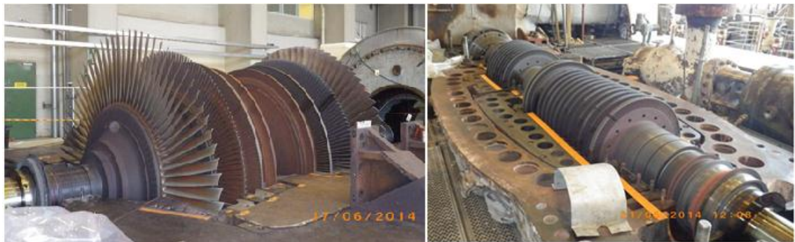
Kuva 5. Kuvassa on vasemmalla matalapaineturbiini ja oikealla korkeapaineturbiini sisäpesissä. Korkeapaineturbiinin pinta-ala on pienempi kuin matalapaineturbiinin, sillä korkean höyryn paineen tilavuus on pienempi kuin matalan paineen. Laitoksesta riippuen matalapaineturbiineja voi olla useampi. [13.]
