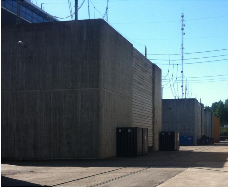
Kuva 11. Voimalaitoksen päämuuntajat sijaitsevat omissa bunkereissaan voimalaitoksen ja kytkinkentän välissä. Bunkkerit suojaavat muuntajan ympäristöä mahdolliselta onnettomuudelta, kuten muuntajapalolta. Vastaavasti ne suojaavat muuntajaa ympäristön haitoilta.
