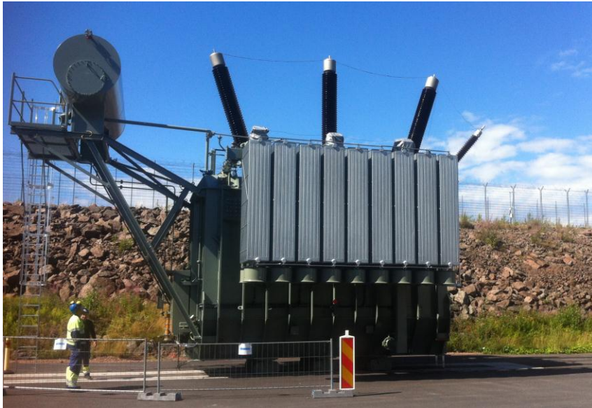
Kuva 10. Voimalaitoksen päämuuntajien varamuuntaja. Muuntajan valmistaja on SMIT. Nimellisteho on 300 MVA ja jännitetasot 415 / 15,75 kV.
