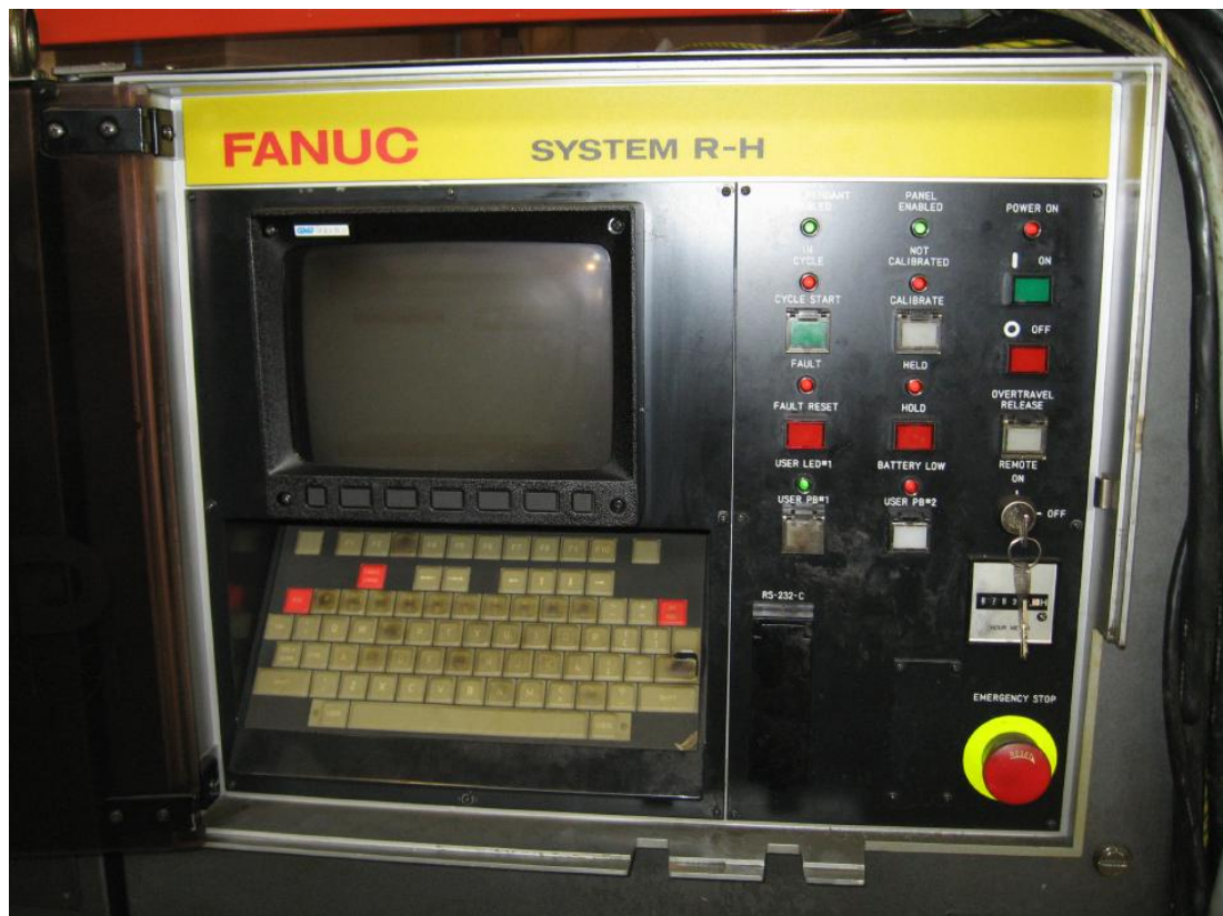
Kuva 4. Fanuc S-700 –robotin ohjausjärjestelmä.
