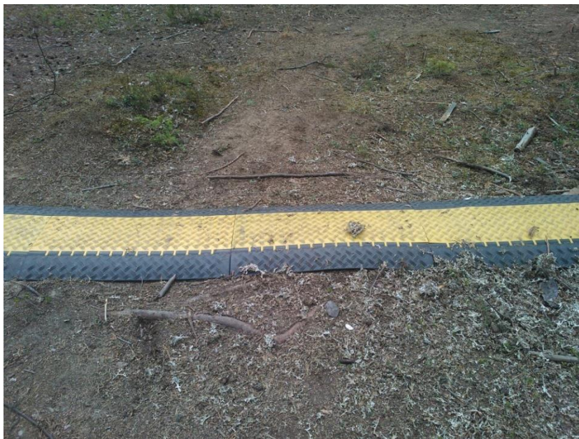
KUVA 3. Kaapelisuoja (Mika Karjalainen 2013.)
