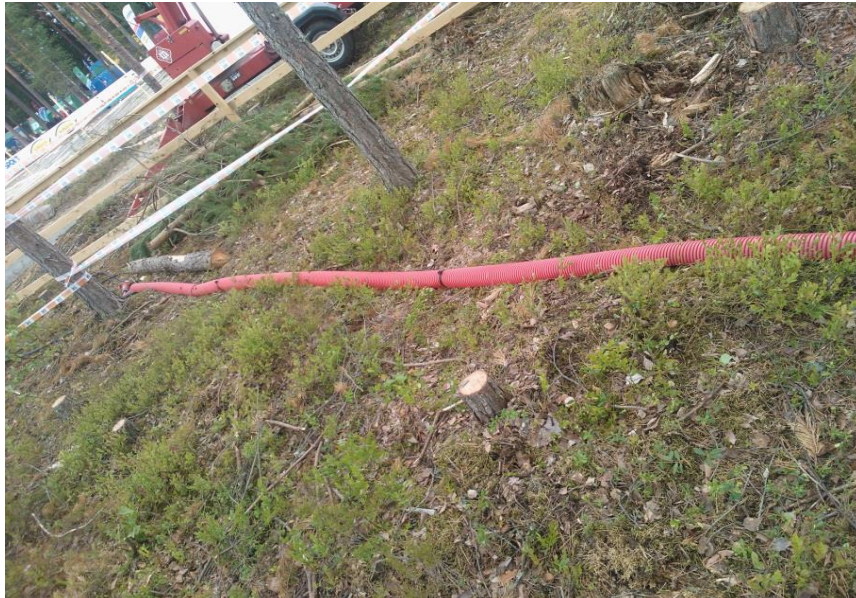
KUVA 4. Putkella suojattu kaapeli (Mika Karjalainen 2013.)
