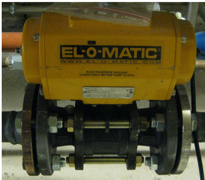
Kuva 26. Uuden linjan pneumaattinen moottoriventtiili.
