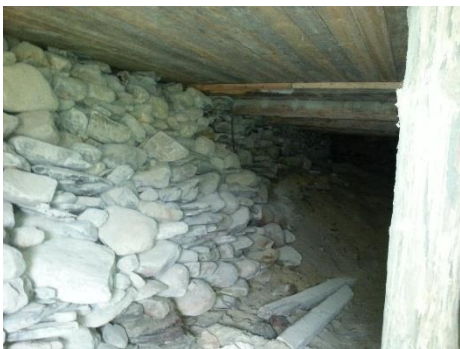
Kuva 18. Kiviladelmä siisti, tuuletus riittämätön
