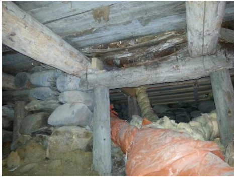
Kuva 12. Alapohjan kosteus- ja lahoaurio
