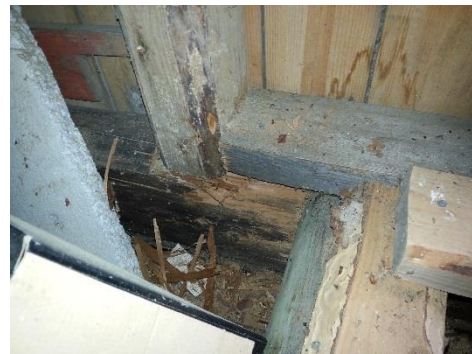
Kuva 8. Portaiden läpiviennin lahovaurio
