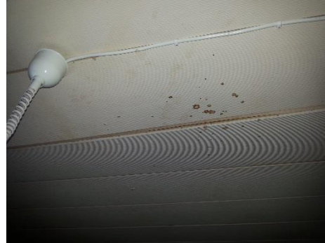
Kuva 25. Romahtanut sisäkatto ja kosteusjälkiä.
