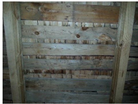
Kuva 6. Vesikatteen alla ei kondenssisuojaa vaan vanhat katemateriaalit
