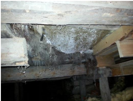
Kuva 14. Alapohjasta puuttuu iso pala
