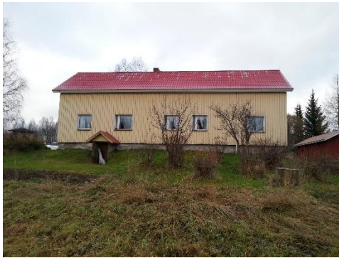
Kuva 5. Vesikatteen maali vaurioitunut
