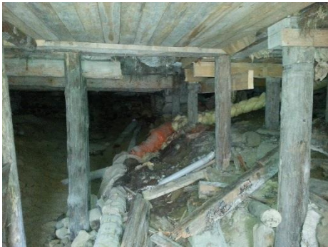
Kuva 16. Alapohjaan kuulumatonta materiaalia
