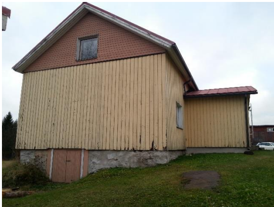
Kuva 4. Sadevesijärjestelmät ja salaojat puuttuvat, kallistukset osittain väärin.
