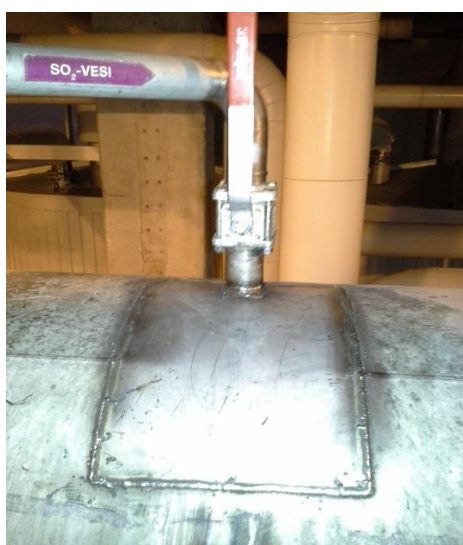
Kuva 25. Rikkihapon syövyttämä korjattu putki
