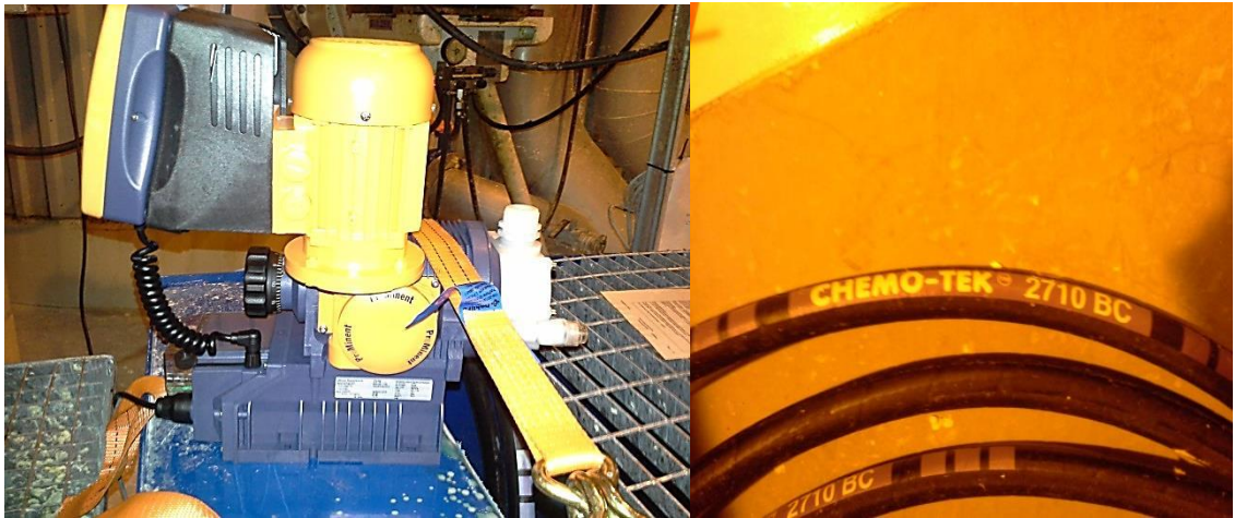
Kuva 21. Rikkihapolle asennettu moottorikäyttöinen haponkestävä ProMinent Sigma kalvoannostelupumppu ja haponkestävä Chemo-Tek 2710 BC letku
