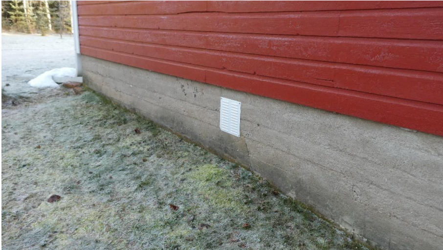
KUVA 5. Tuuletusaukot suojattu siihen tarkoitettu säleiköllä. Ei tietoa millainen luukku paikalla on ollut enne kunnostustöitä.
