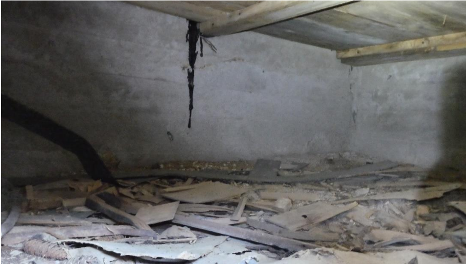
KUVA 2. Sokkeli alapohjasta kuvattuna. Valumajälki liittyy todennäköisesti puurakenteiden kosteudelta suojaamiseen, johon on käytetty ennen esimerkiksi tervaa.
