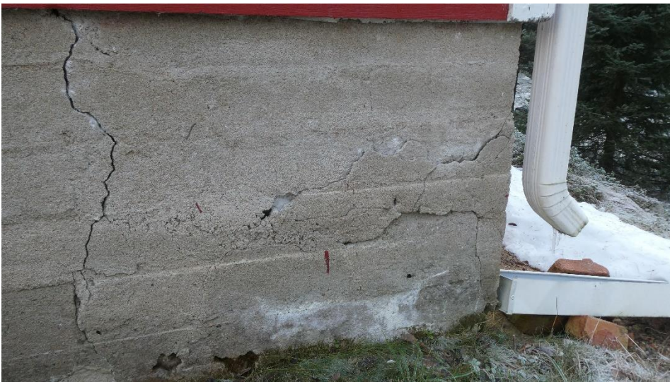
KUVA 3. Sokkelissa halkeamia rannan puolen nurkissa. Aiheuttajana todennäköisesti routa ja maan liike.
