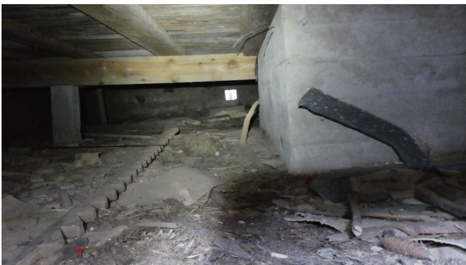
KUVA 4. Tuulettuva alapohja. Oikealla nähtävissä uunin perustukset ja maassa päreiden asentamisessa käytetty muotti.
