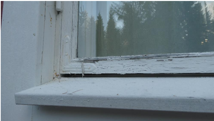
KUVA 8. Maalin hilseilyä ikkunan puitteissa. Jos ikkunat haluaisi ennallistaa tulisi vanha maali poistaa ennen uudelleen maalausta.
