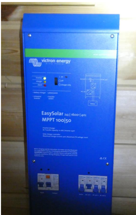
KUVA 14. Aurinkopaneelien invertteri akkuineen sijoitettuna sisälle portaiden alle.
