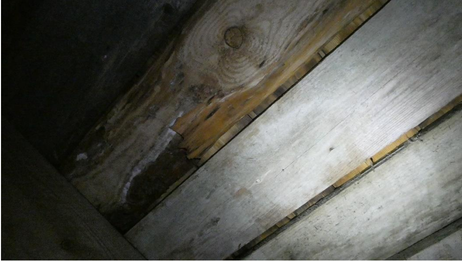
KUVA 10. Alkuperäinen pärekatto on nähtävissä ruoteiden välistä. Ruoteet ajanpatinoimat ja lahoamista havaittavissa.
