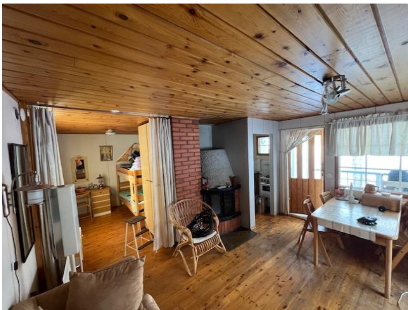
KUVA 3. Kohteen tupa, jonka lattiapinnoissa havaittavissa kulumisen jälkiä (Kuva: Eino Pakarinen).
