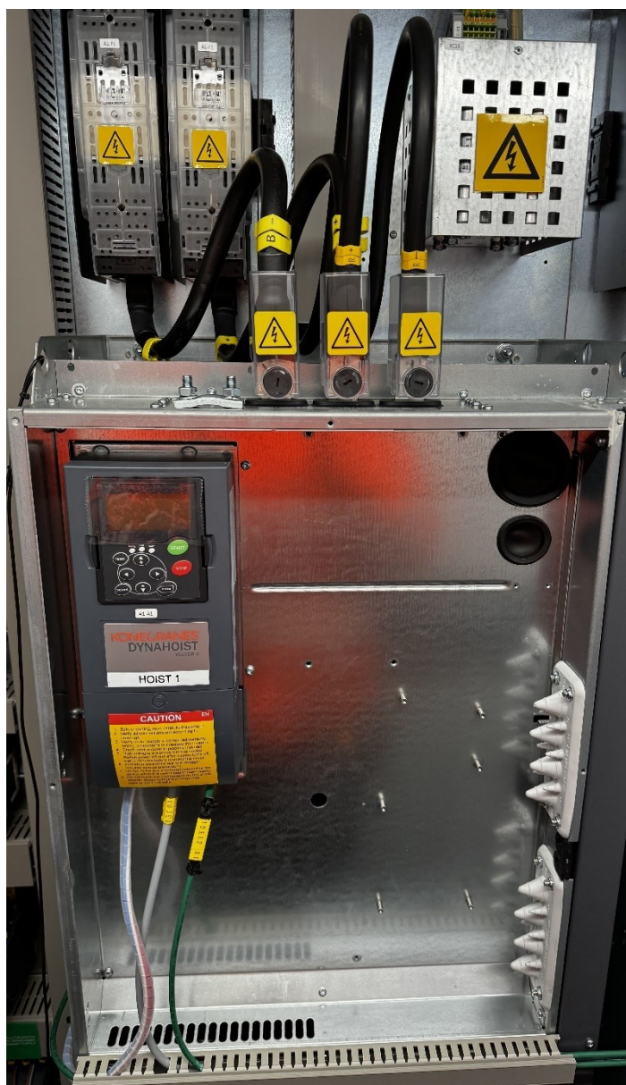
KUVA 6. DynAHOist taajuusmuuttaja nosturin sähköhuoneessa
