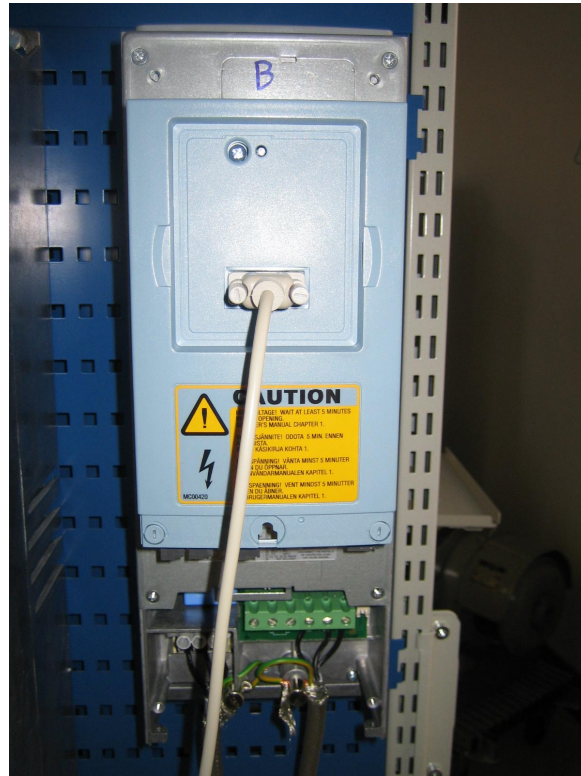
Kuva 16. Testilaitteiston moottoripuolen ohjauksessa käytettävä Vaconin NXP
