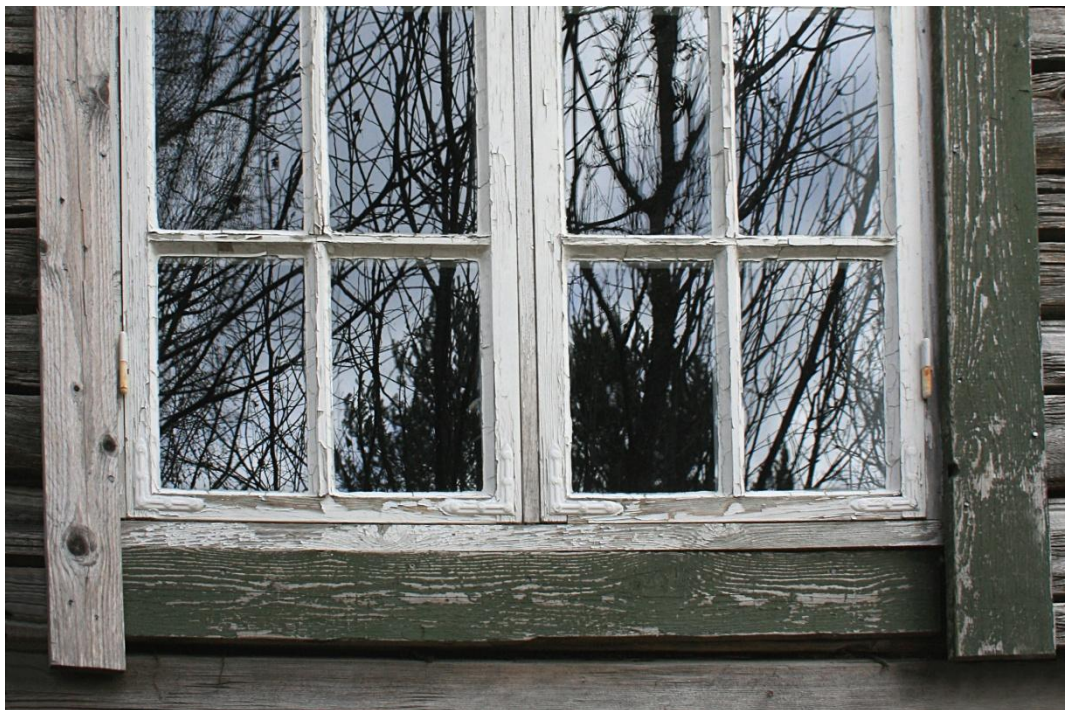
Kuva 19. Ikkunankarmien maali on rapissut pois.
