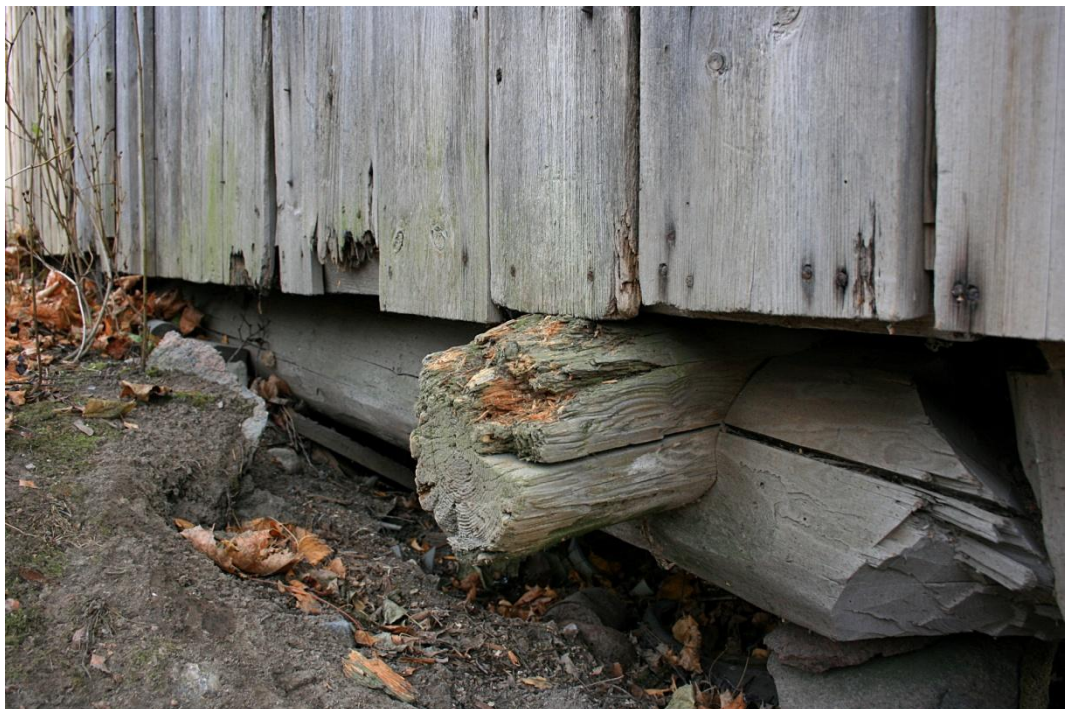
Kuva 13. Luoteisnurkassa hirren pää on lahonnut yläpuolelta.
