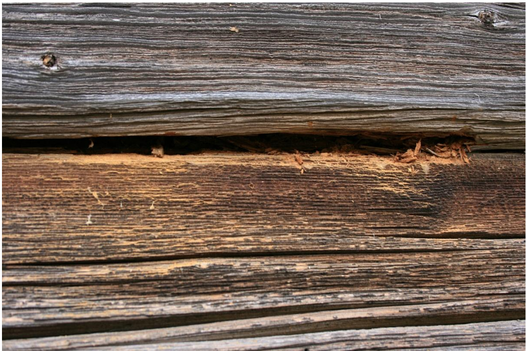
Kuva 18. Hirsien ala- ja yläreunat ovat lahoja.
