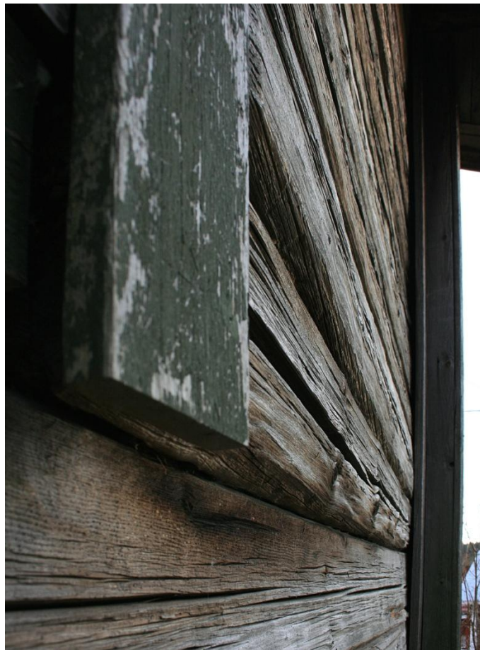
Kuva 14. Seinä aaltoilee vertikaalisesti.
