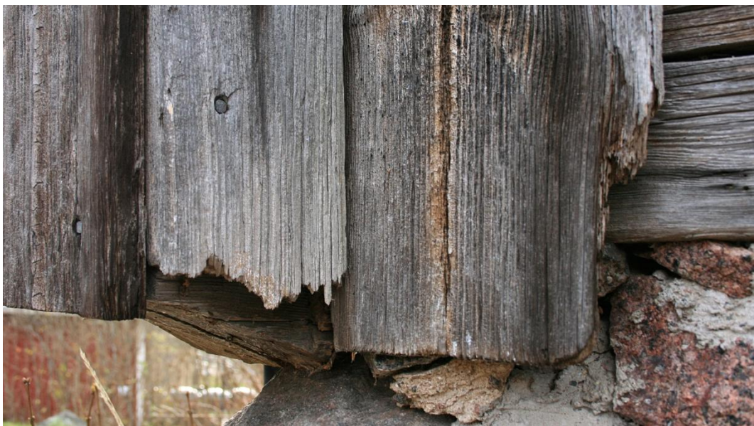
Kuva 17. Nurkkaa suojaava laudoitus on lahoa alapäästä, ja siinä näkyy mustaa homekasvillisuutta.
