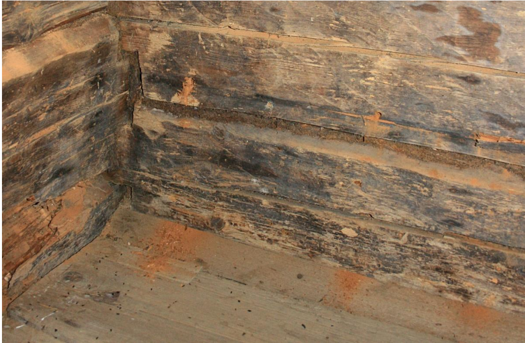
Kuva 21. Tuvan luoteisnurkassa on lahoa niin pitkällä kuin väliseinälläkin.
