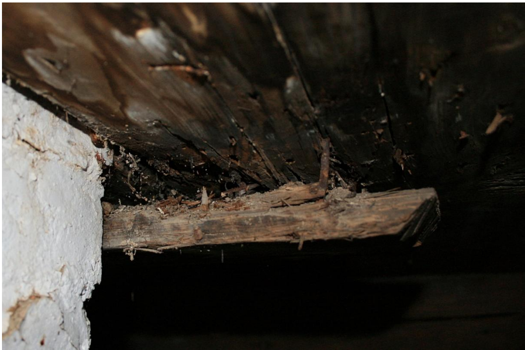
Kuva 20. Savupiipun nurkassa olevan laudan alla on pehmeää lahoa.
