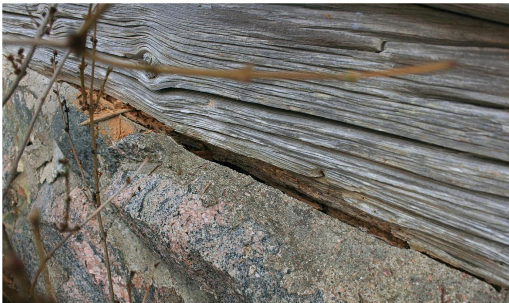
Kuva 15. Vesi on päässyt sementin ja alimman hirren väliin.
