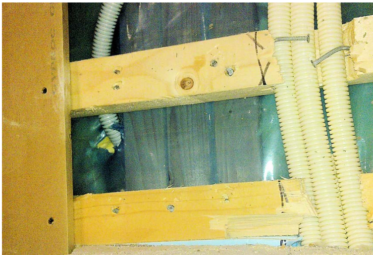
Kuva 5. Ulkoseinässä oleva sähköputken läpivienti
