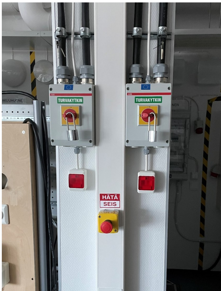
Kuva 29. Lukon takana oleva sähkönsyöttö.
