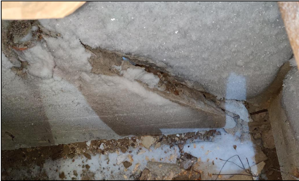
Kuva 4. Sokkelipalkki poikki 8 cm siirtymä
