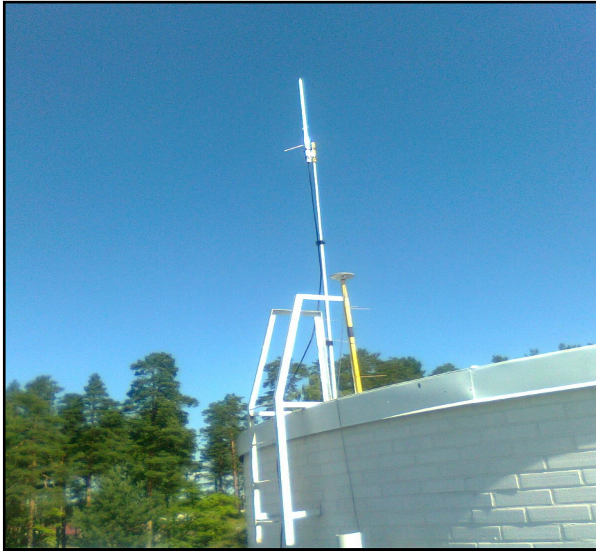
Kuva 6. Tukiaseman antenni kunnantalon katolla.
