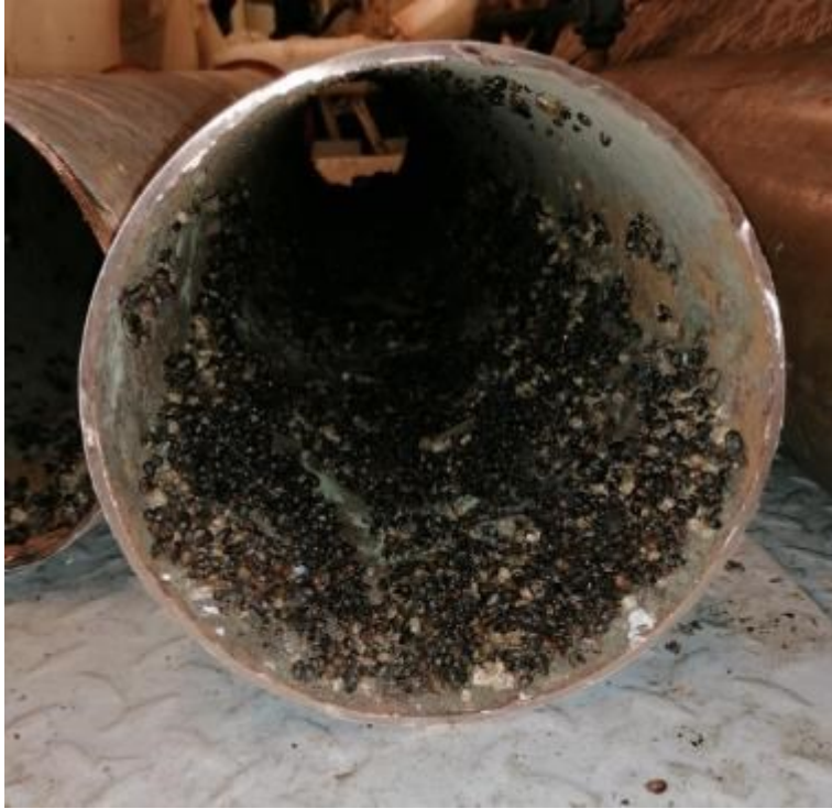
Kuva 1. Kasvustoja merivesiputkessa (Karpoff 2020)
