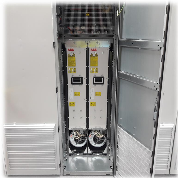
Kuva 12. Kuormakuristimet asennettuina omiin kammioihinsa.
