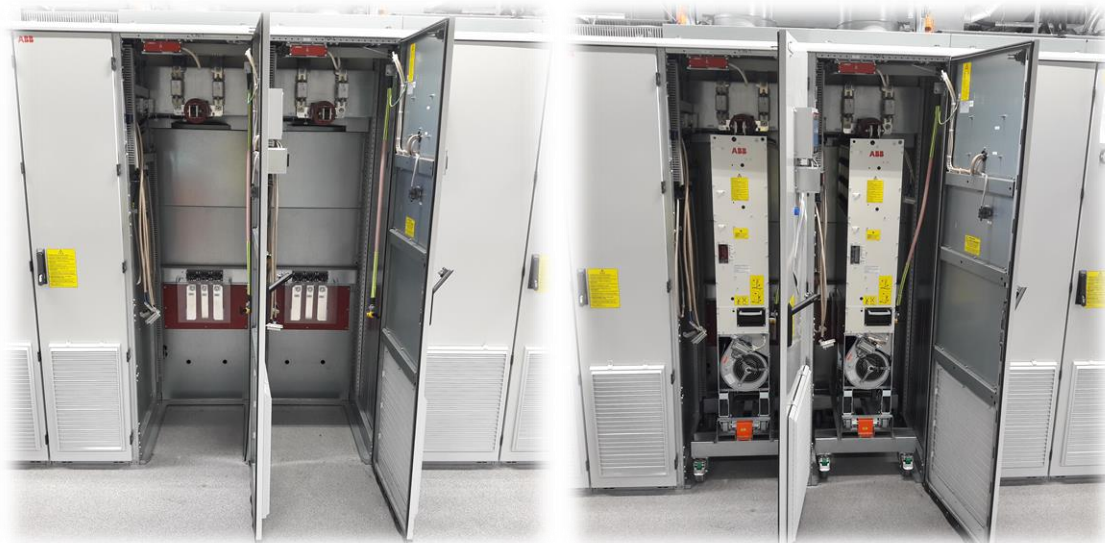
Kuva 15. ACS800-R8i-moduulien koestuskammiot ja R8i-moduulit asennettuina omiin koestuskammioihinsa.
