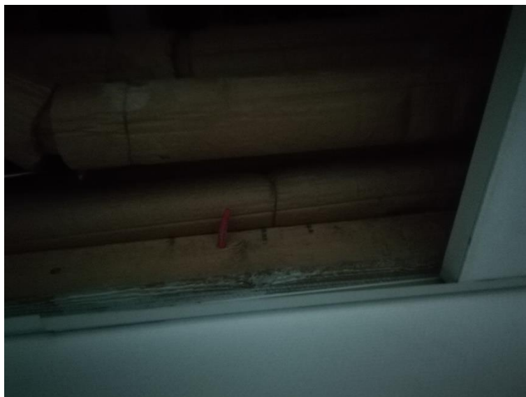
Kuva 23. Tilan 3 avonainen kohta välikatosta.
