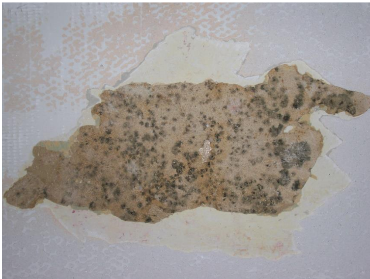
Kuva 3. Rakennuksen väliseinässä olevaa mikrobivauriota.
