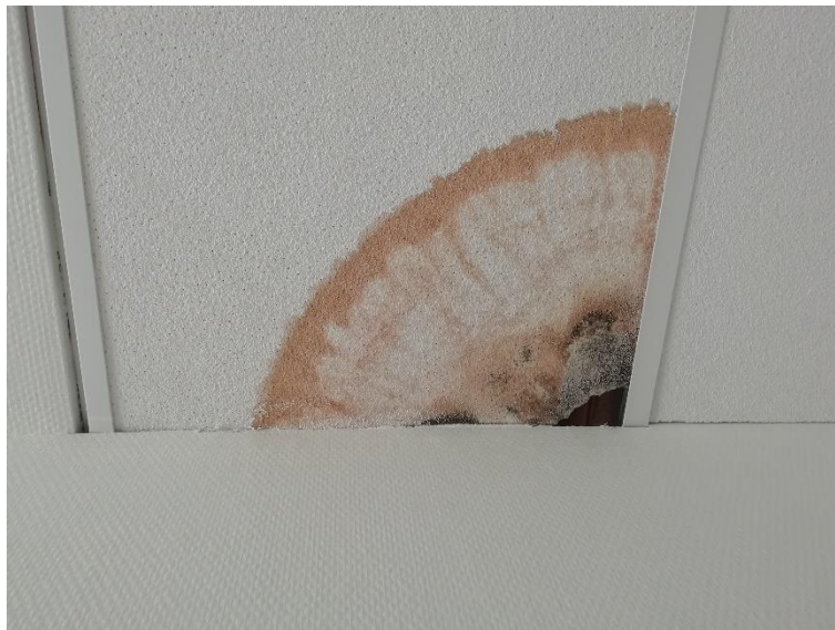
Kuva 25. Tilan 11 kattopaneelissa oli reikä.
