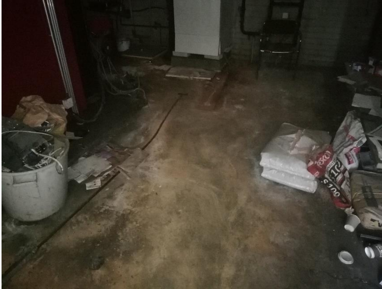
Kuva 27. Lämmönjakohuoneen likainen ja pölyinen betonilattia.
