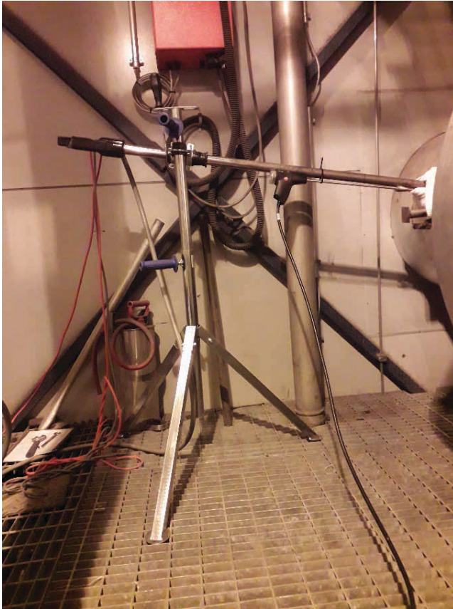
KUVA 4. Päästömittausta Tikkalan höyrylämpölaitoksella (kuva Niina Laurila).
