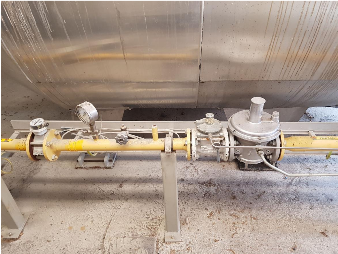
KUVA 8 Kattilaan menevän nestekaasun syöttöputkessa on kulutusta mittaava kuutiometrimittari (aivan vasemmalla) ja painemittari (viisarimittari oikealle mentäessä).
