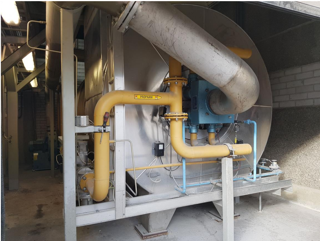
KUVA 5 Kaasupoltin ja kattila
