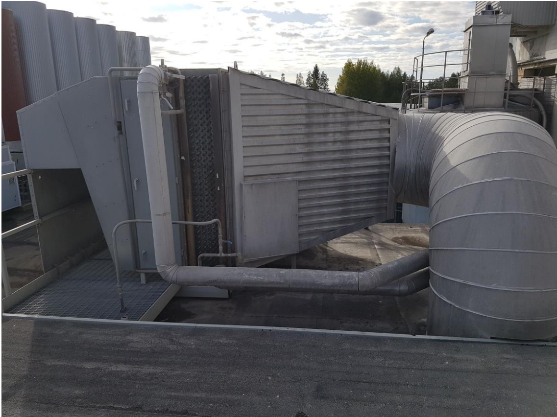
KUVA 7 Lämmönsiirtimen alakenno lämmittää ulkoa imettävää ilmaa.
