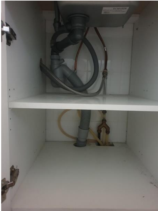
KUVA 12. Kodinhoituhuoneen allaskaapissa haarautuu lämpimän käyttöveden ja kylmän veden putket pesualtaan hanalle ja pyykinpesukoneen venttiileille.
