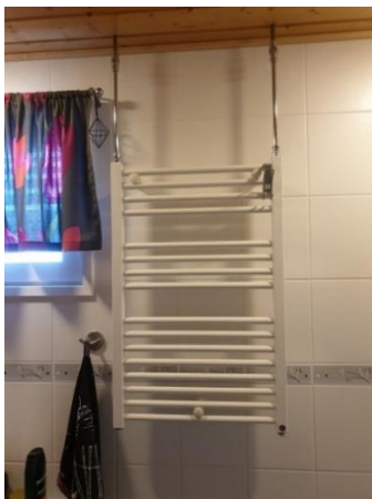
KUVA 7. Kylpyhuoneen kuivauspatteri sijaitsee viimeisenä patteriverkostossa. Kuvassa näkyy alaslaskussa tuodut vanhat kupariputket ja sulut, jotka olivat kiinni estäen veden virtauksen kuivauspatterissa.
