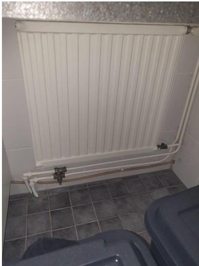
KUVA 8. Kodinhoitohuoneen käsisäätoinen patteri, haarat lattialämmitykselle sekä pintaan uusittu käyttövesiputki.
