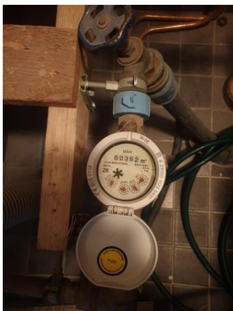
KUVA 11. Vesimittarissa ei havaittu liikettä vesipisteiden ollessa suljettuina tarkastuksen aikana.
