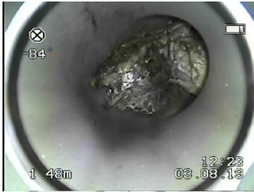
KUVA 4. Saunan kiukaan korvausilmaputken mutkasta löytyi isompi tukos.
