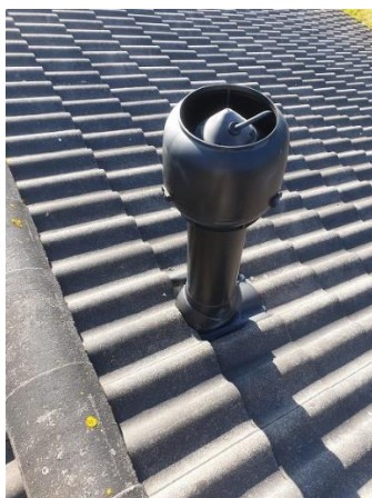
KUVA 24. 2015 uusittu liesituuletin, jolla ohjataan vesikatolla sijaitsevaa huippuimuria. Samaa kanavaan on yhdistetty talon muut poistoilmakanavat.
