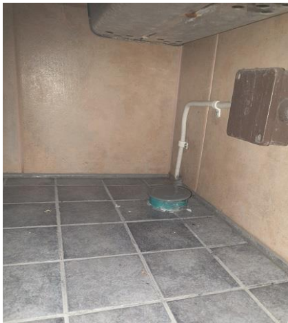
KUVA 3. Saunan puukiuasvarauksen alapuolella oleva korvausilmaventtiili
