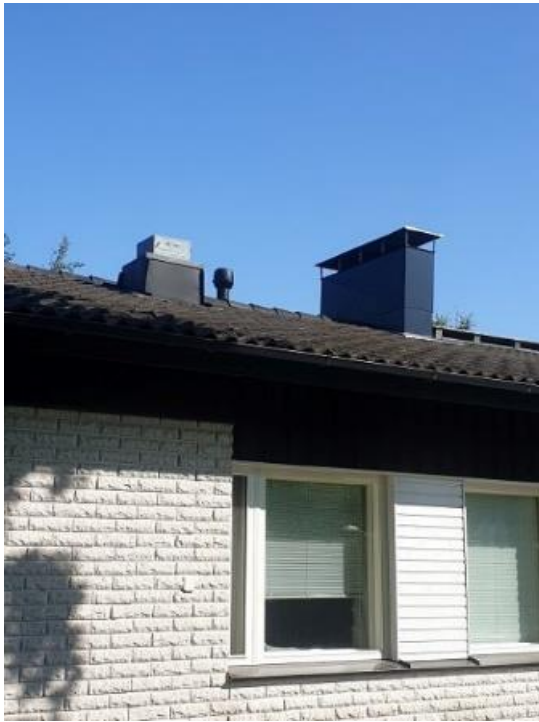
KUVA 1. Kuntoarviokohteen keittiön liesituulettimen puhallin ja käytöstä poistettu ilmanvaihtokone sijaitsevat rakennuksen vesikatolla.
