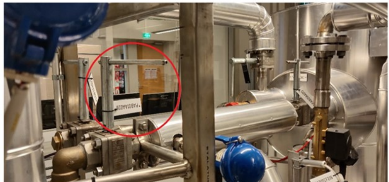
Käsiventtiili PAB01AA026 (Jäähdytystehon säätö)
