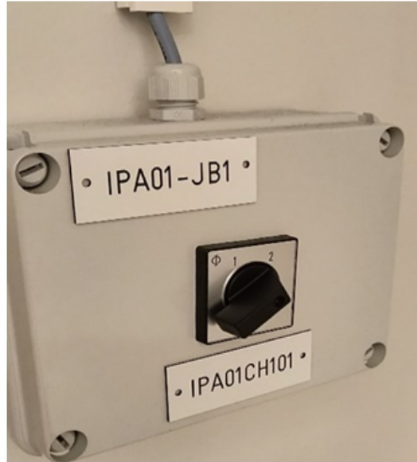
Paineilmasyötön kytkin päällä
