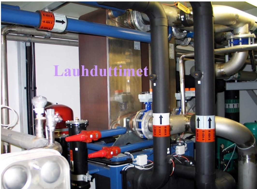
KUVA 6. Alfa-Lavalin CB300-140H-levylämmönvaihdin konehuoneessa
