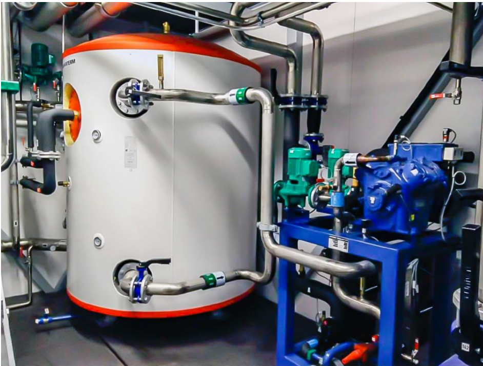
KUVA 12. Lauhdelämpöpumppu 100 kW ja tulistuslämmönvaraaja sijoitettuna jäähallin konehuoneeseen (Mukaiillen Mansikkaviita 2018.)
