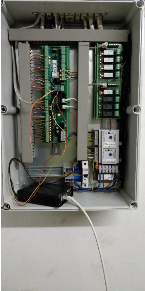
KUVA 3. Alakeskuslaitteisto, Caverion CWS ja MIO-52
