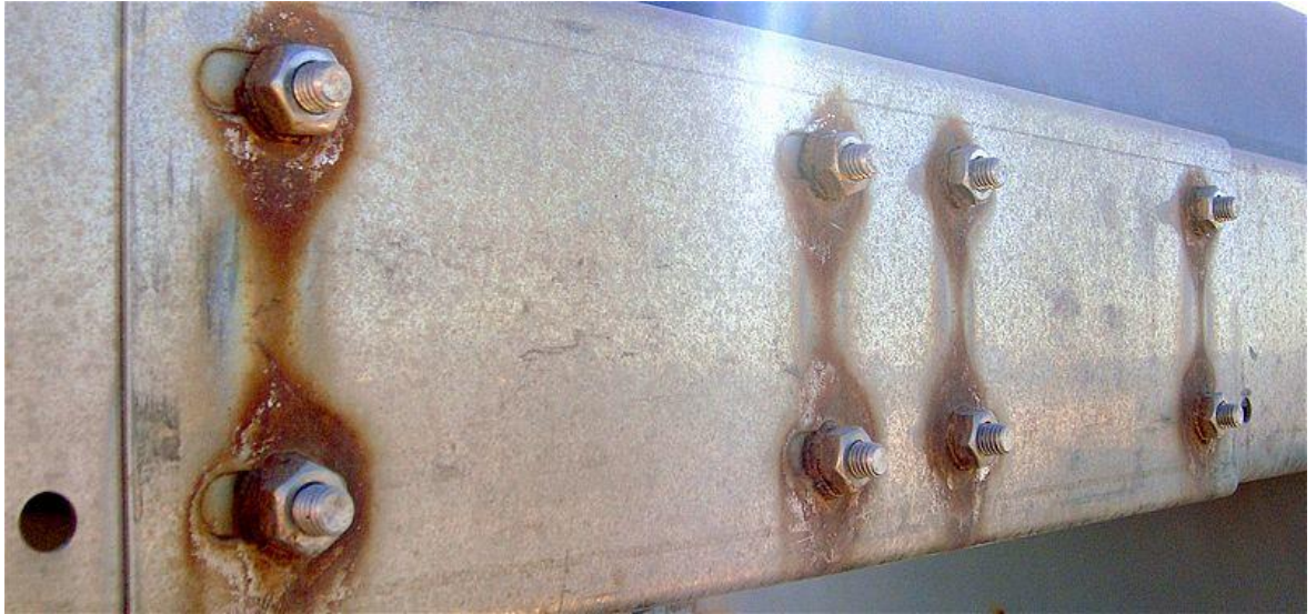
Kuva 14. Galvaanista korroosiota (Wikipedia Commons 2016b.)
